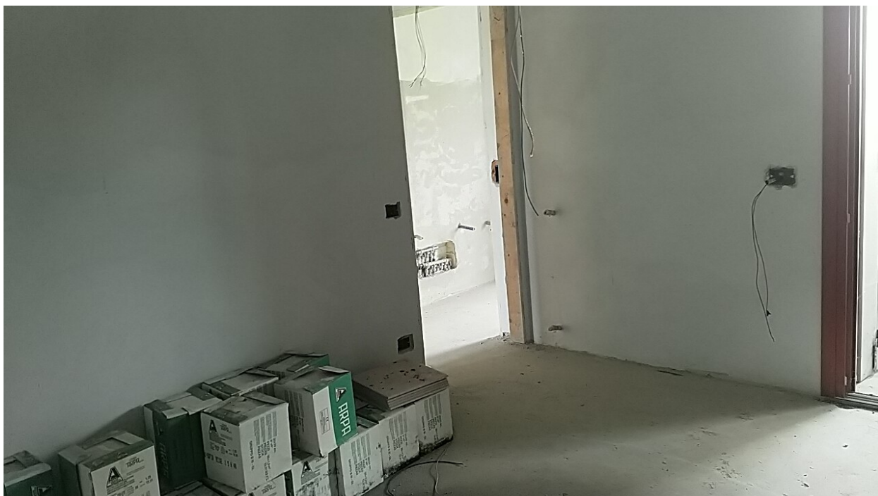
Sesto al Reghena, via Buse – La camera singola e le vistose infiltrazione dal soffitto e dai muri.
