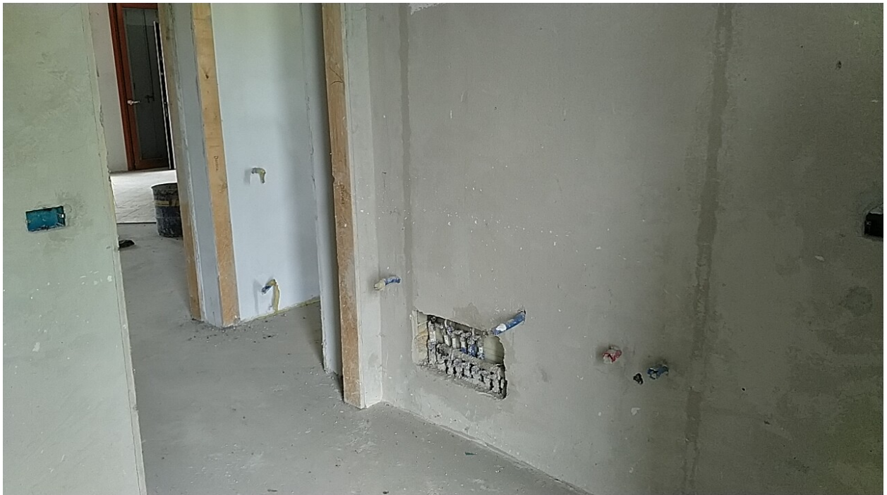
Sesto al Reghena, via Buse – Il bagno e le infiltrazione dal soffitto e dai muri.
