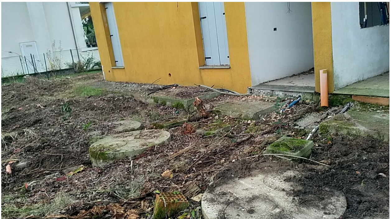
Sesto al Reghena, via Buse – Sopra il vano per l'installazione della caldaia e dei collettori, i pozzetti della fognatura in giardino.
