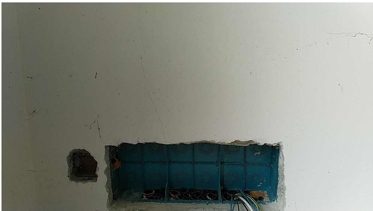
Sesto al Reghena, via Buse – Particolari dei collettori dell'impianto idrico e della scatola di derivazione dell'impianto elettrico.
