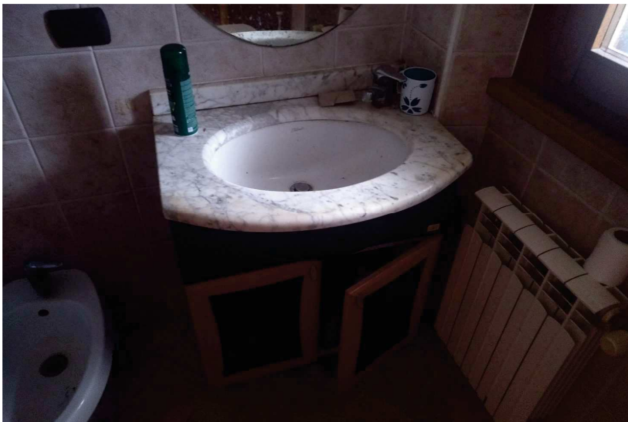
Foto n. 16 – Sanitario lavello del bagno.
