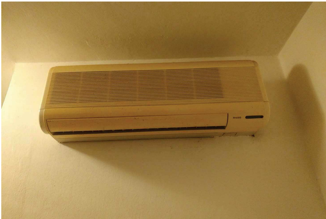
Foto n. 19 – Unità interna climatizzatore.
