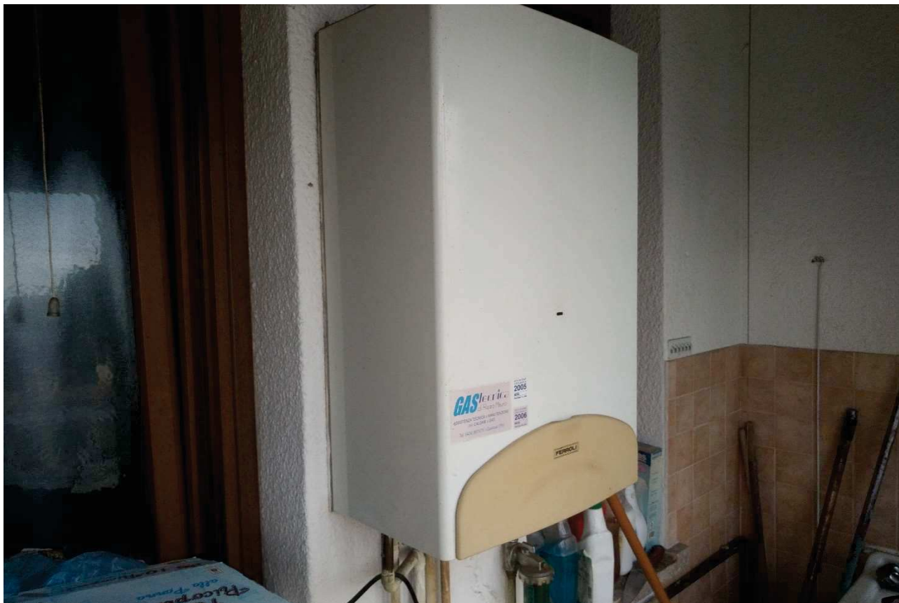
Foto n. 21 – Caldaia a muro.
