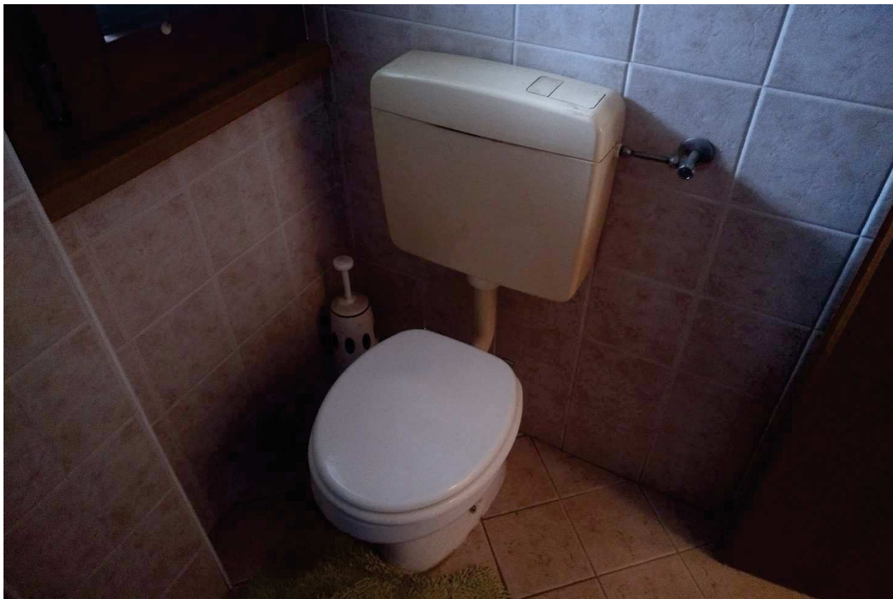
Foto n. 17 – WC con cassetta esterna.
