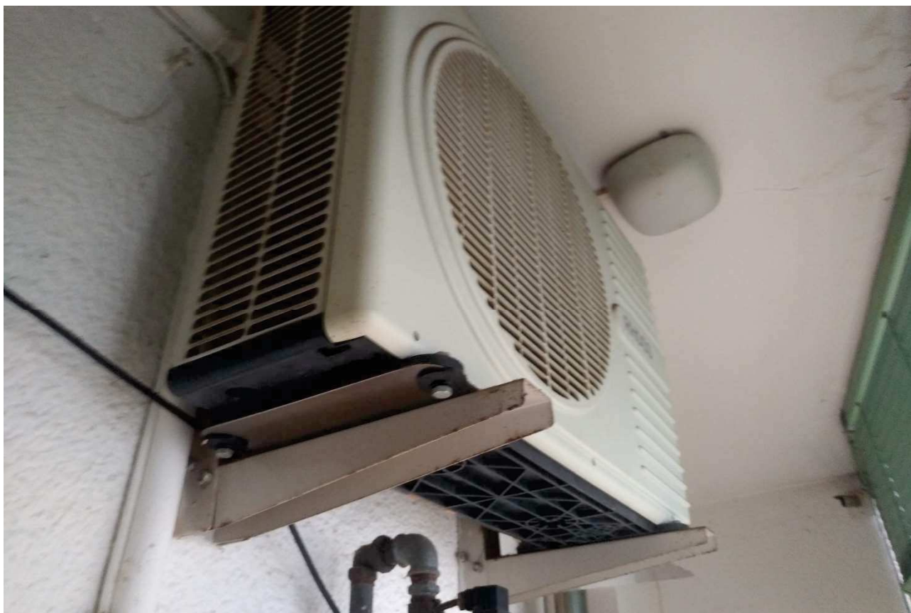
Foto n. 20 – Unità esterna del condizionatore, installata internamente al terrazzino.
