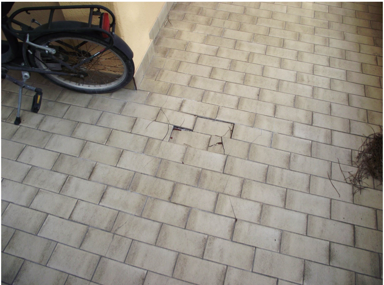
Foto 18 – piastrelle rotte sul terrazzo
