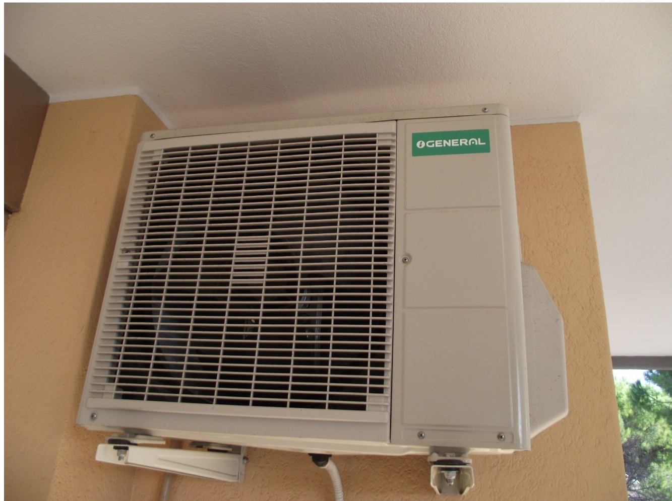
Foto 14 – climatizzatore unità esterna
