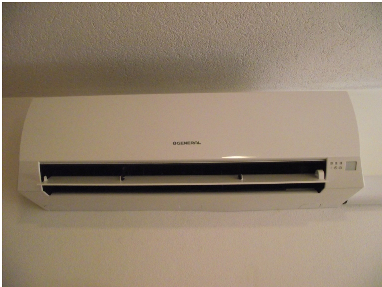
Foto 15 – climatizzatore unità interna
