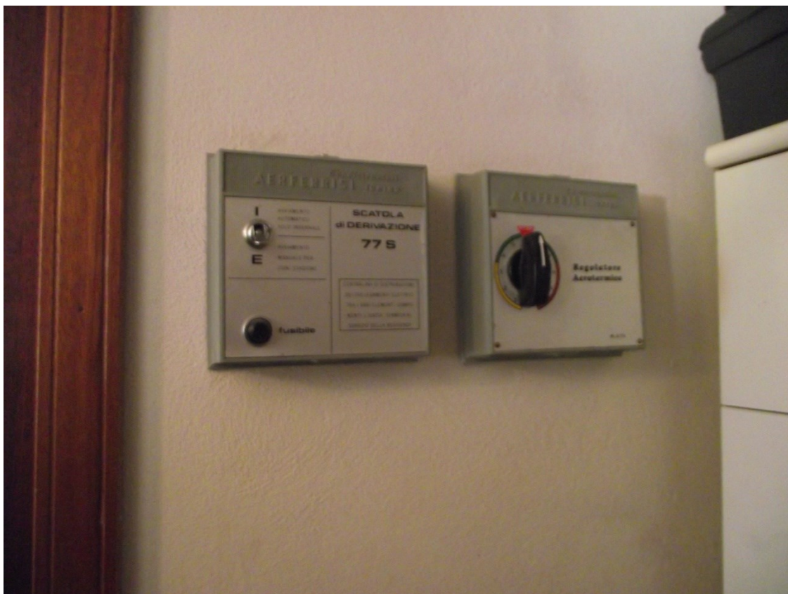
Foto 9 – controlli climatizzatore centralizzato dismesso
