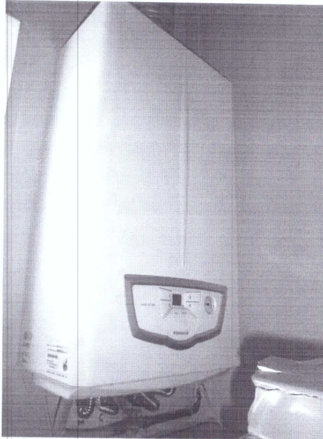
- FOTO 13 - PARTICOLARE DELLA CALDAIA MURALE PENSILE -
