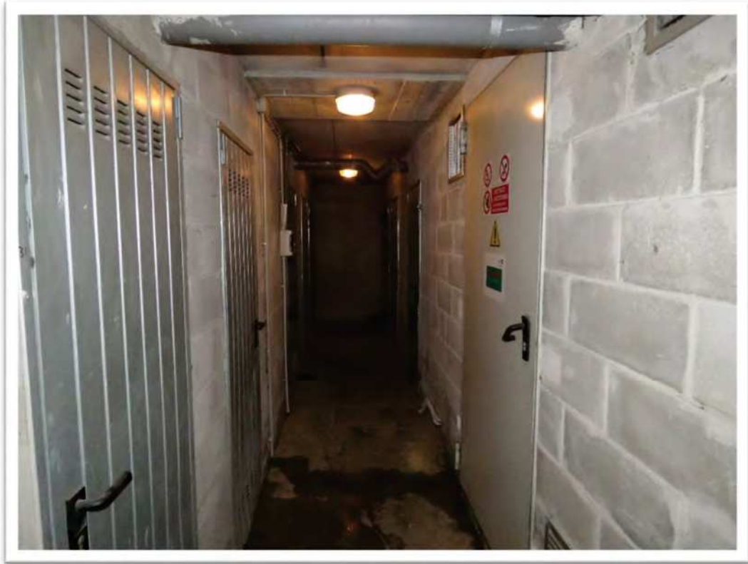
Segni di recente allagamento del pavimento del disimpegno delle cantine.
