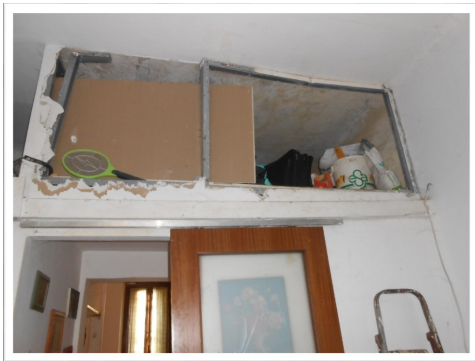
Foto 12 soppalco in quota
