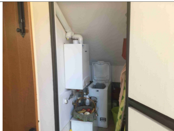
CT (sottoscala) - Sub 7
