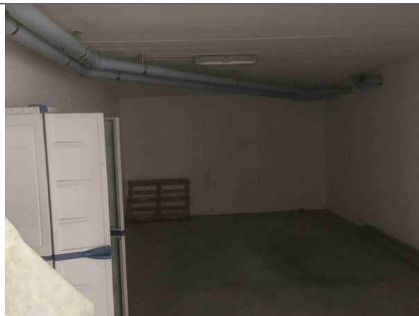
Autorimessa p. S1 - Sub 16
