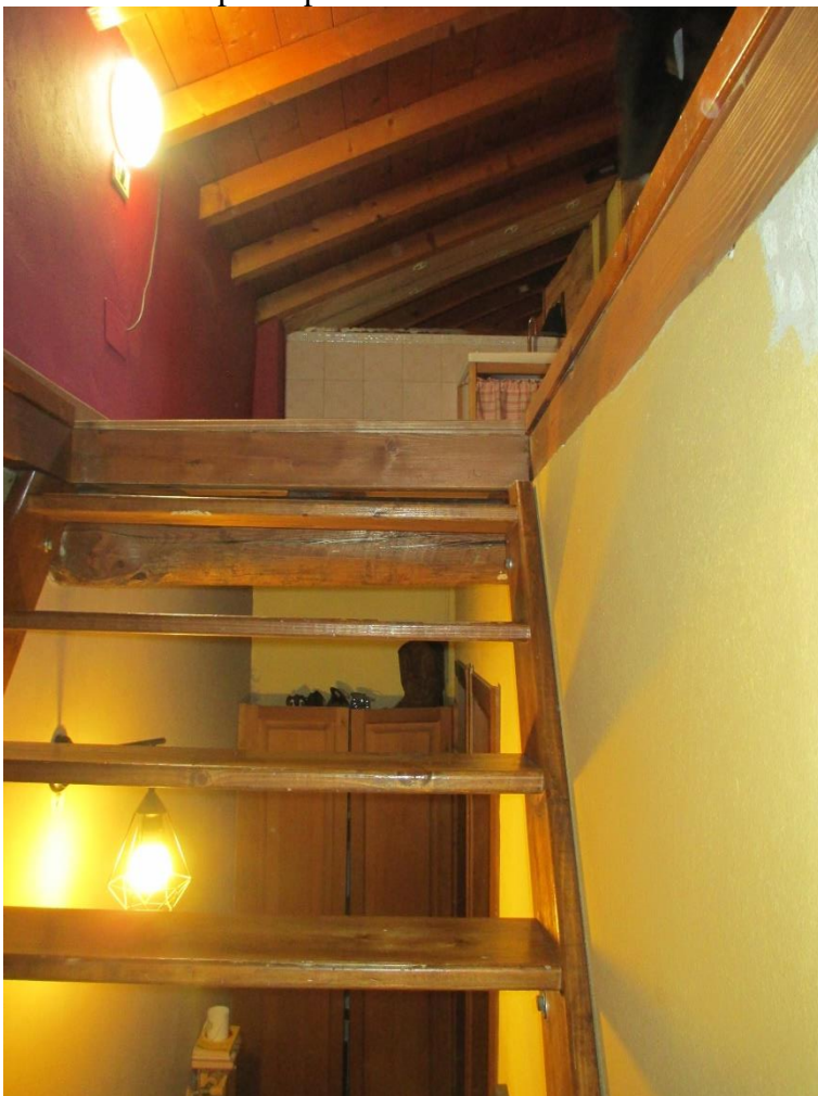
Foto 9: scala verso piano sottotetto abusiva
