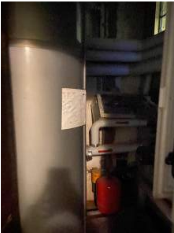
Vista impianti cavedio
