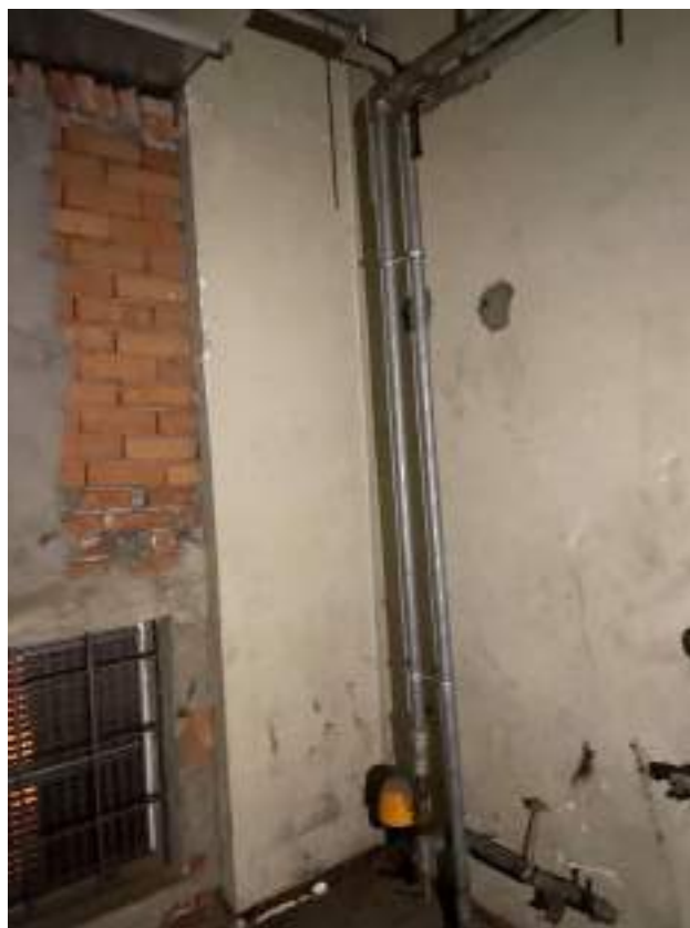
cavedio impianti lato destro
