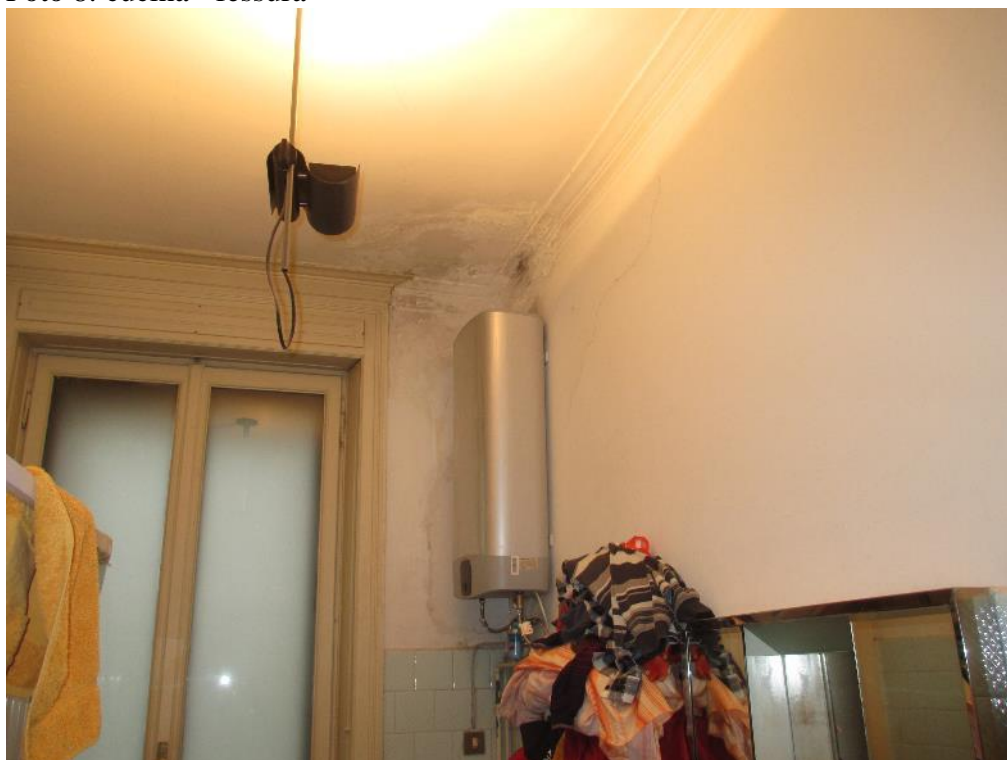
Foto 9: bagno – vecchia perdita
