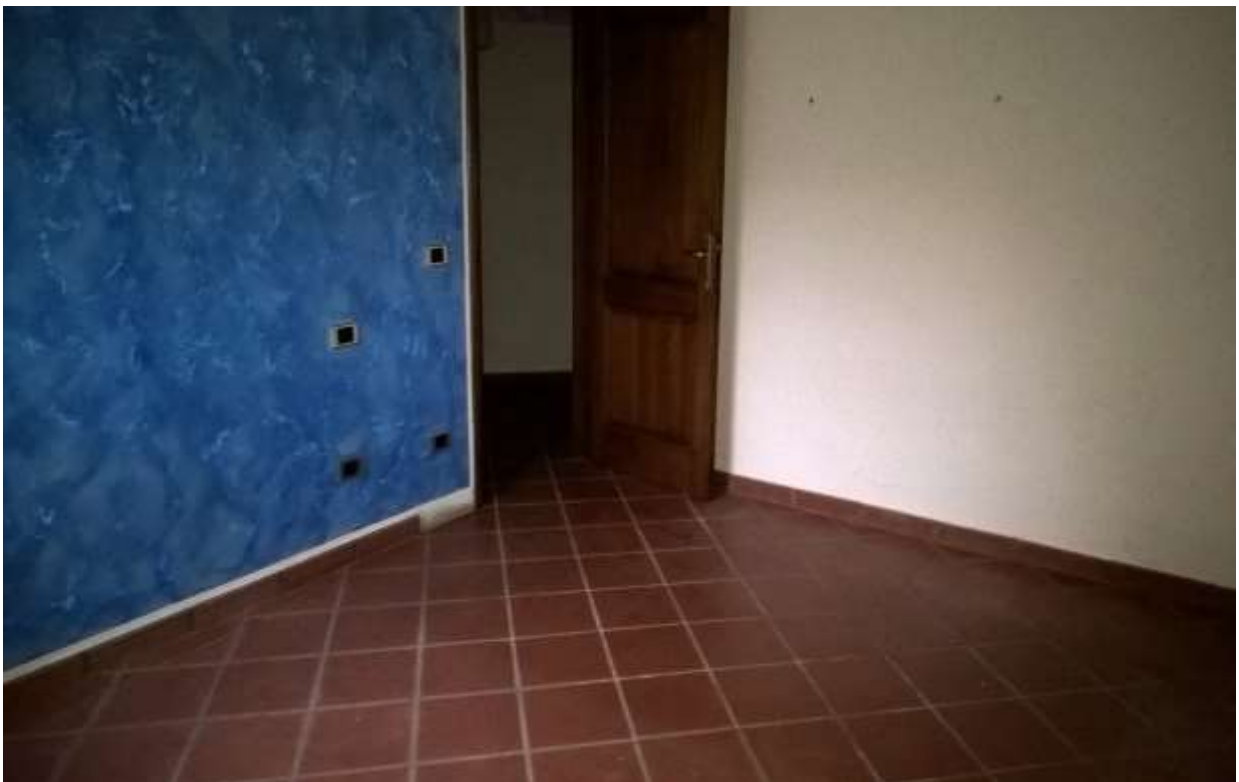
San Vito al Tagliamento, via Oberdan n. 84, piano terra – Il deposito (ex lavanderia).
