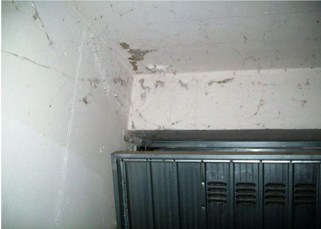
Foto 45a.11: infiltrazione soffitto garage
