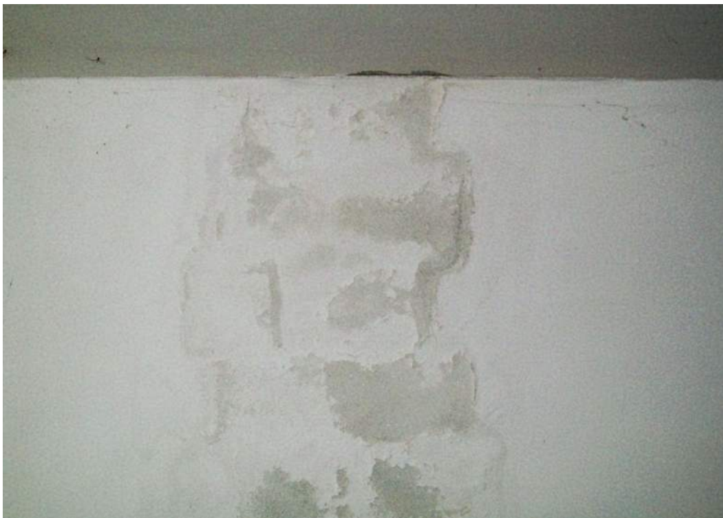
Foto 45a.10: infiltrazione parete garage
