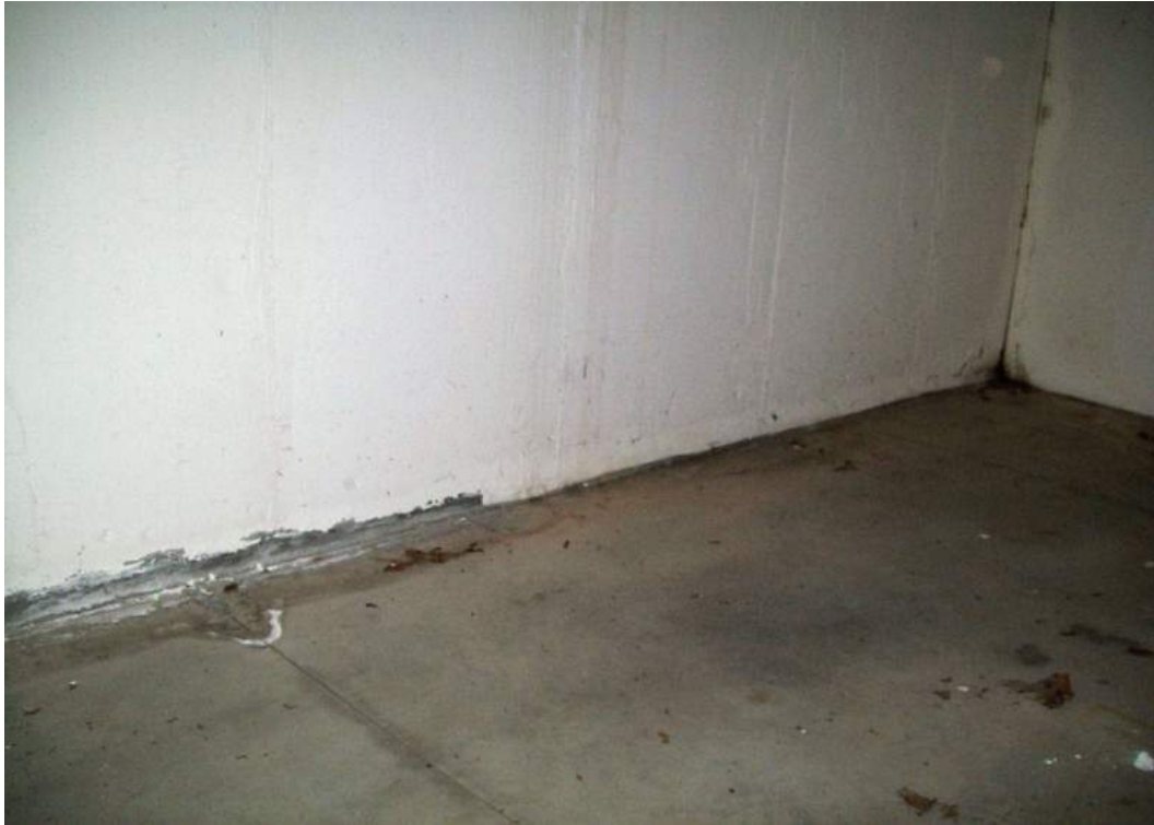
Foto 43c.11: infiltrazioni garage piano interrato
