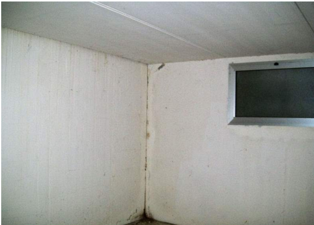
Foto 43c.10: infiltrazioni garage piano interrato
