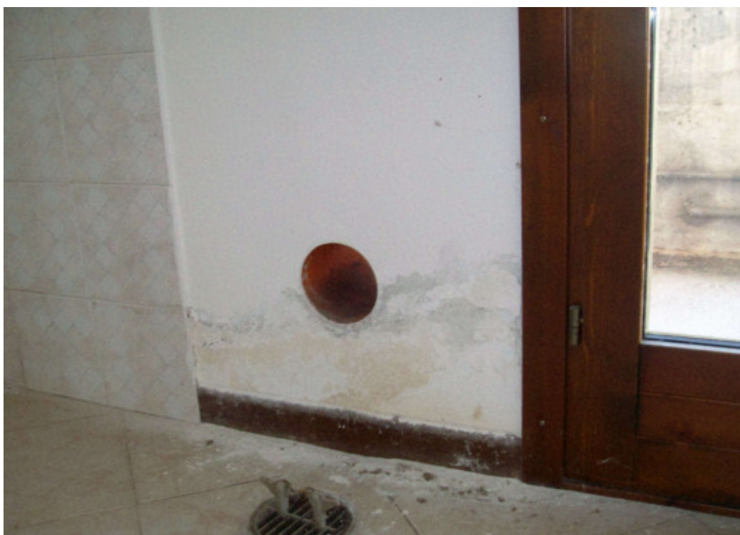
Foto 41b.2: infiltrazioni parete cucina
