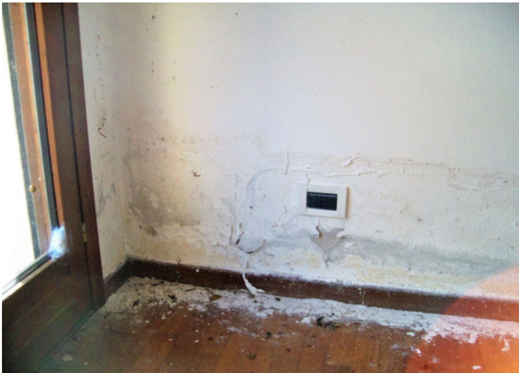
Foto 41b.6: particolare infiltrazione
