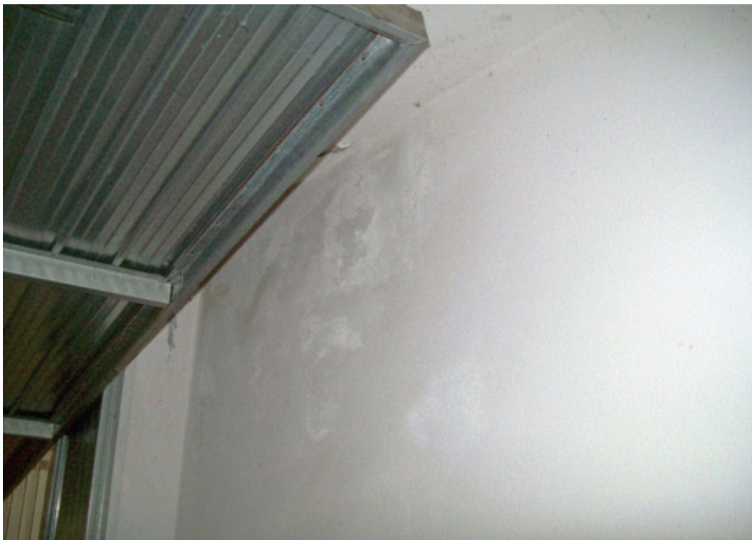
Foto 41b.10: particolare infiltrazione parete divisoria garage
