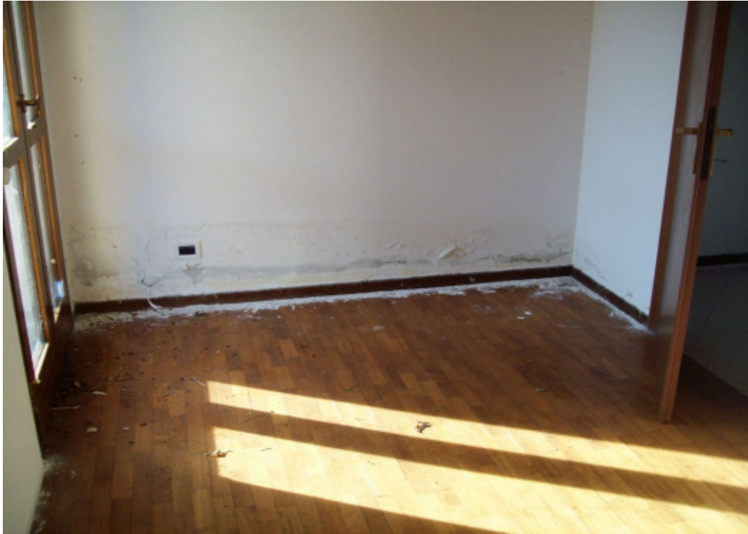
Foto 41b.5: infiltrazioni pareti camera lato Est
