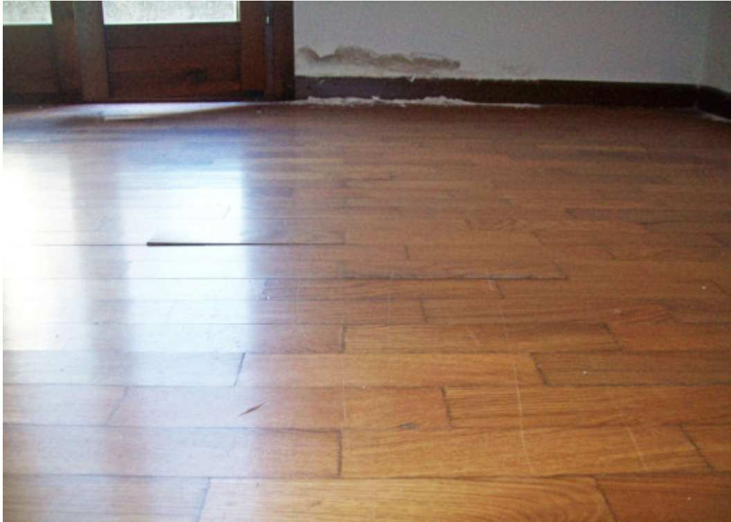
Foto 41b.7: particolare infiltrazioni pavimenti lignei
