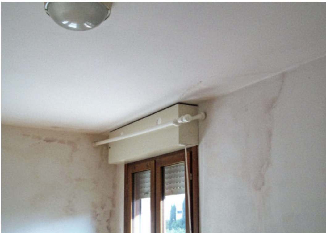
Foto 41a.6: particolare infiltrazioni camera a Est
