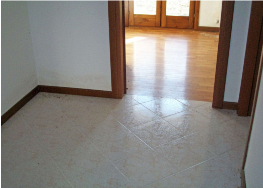
Foto 41a.7: infiltrazioni divisori interni
