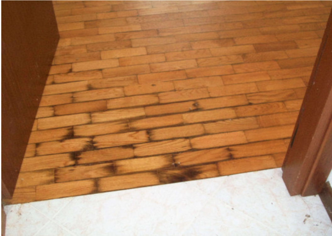
Foto 41a.5: particolare infiltrazione su pavimento ligneo
