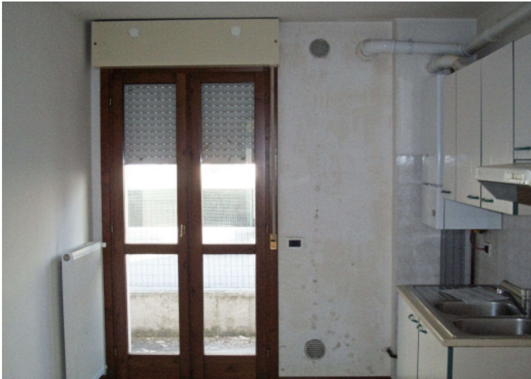
Foto 41a.2: parete Ovest cucina con infiltrazioni
