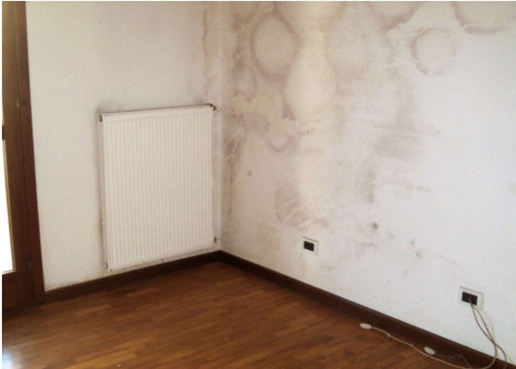
Foto 41a.3: infiltrazioni camera
