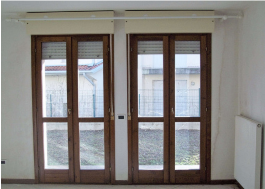
Foto 41a.1: parete Est soggiorno con infiltrazioni
