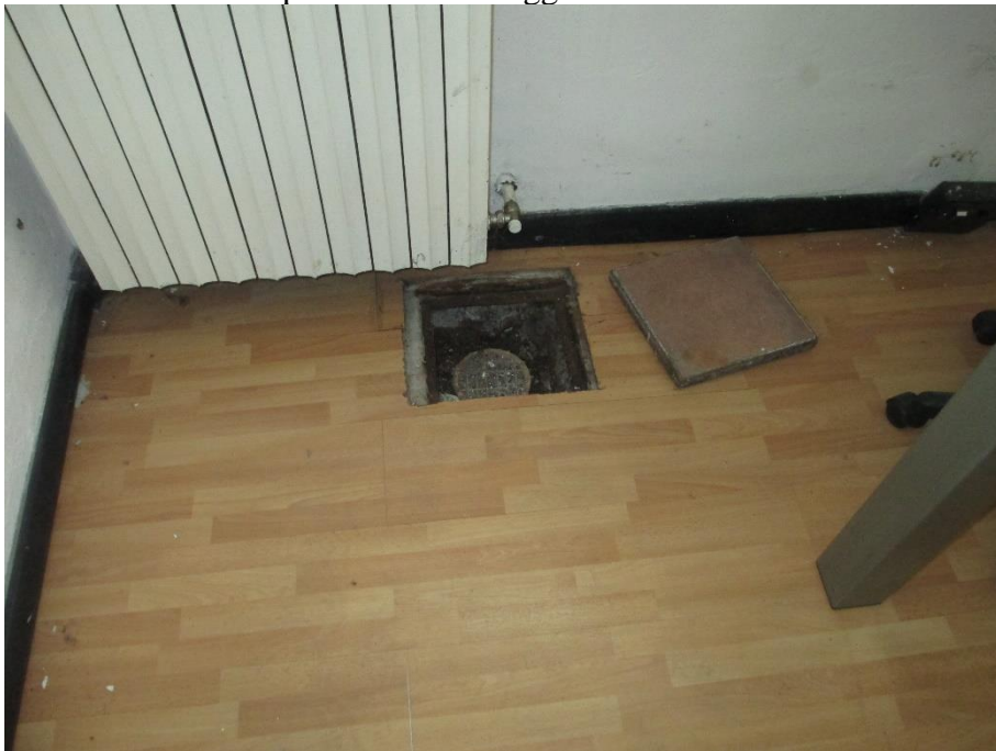
Foto 22: pozzetto di ispezione nell'openspace confine con bagno
