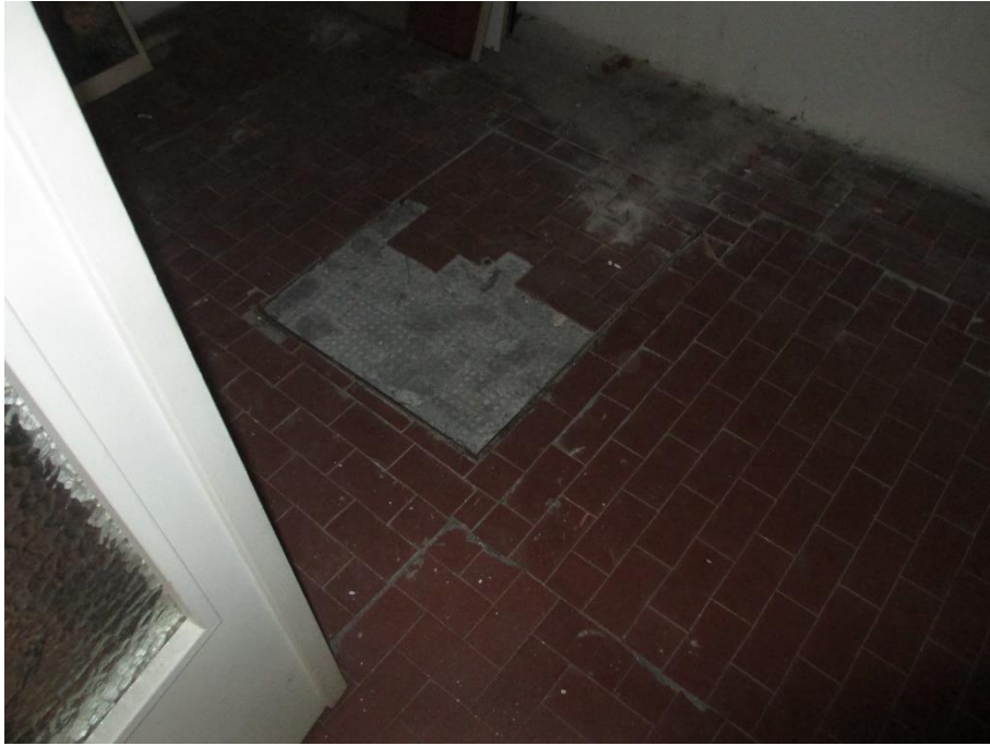
Foto 21: archivio – pavimento danneggiato
