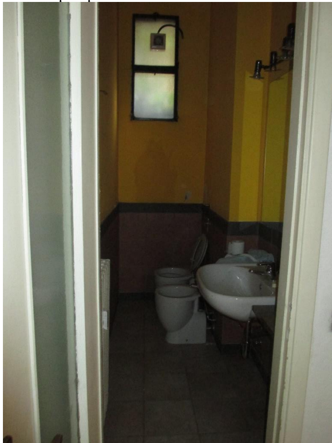
Foto 9: bagno openspace (manca antibagno)
