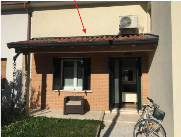
vista esterna del porticato abusivo sul lato Sud del fabbricato -verso via Tramontina-
