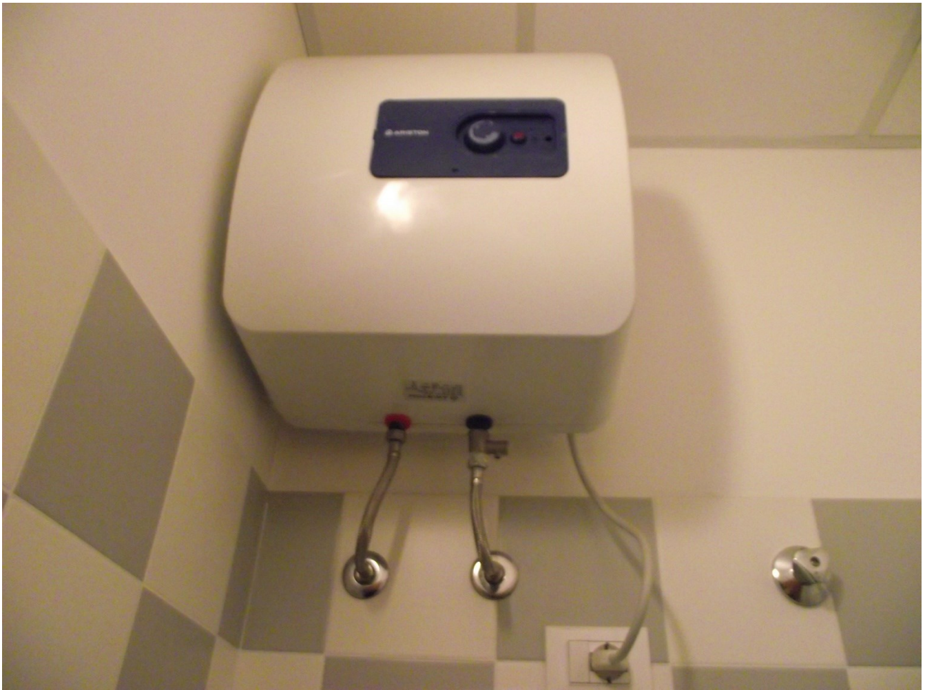
Foto 15 – scaldacqua elettrico bagno
