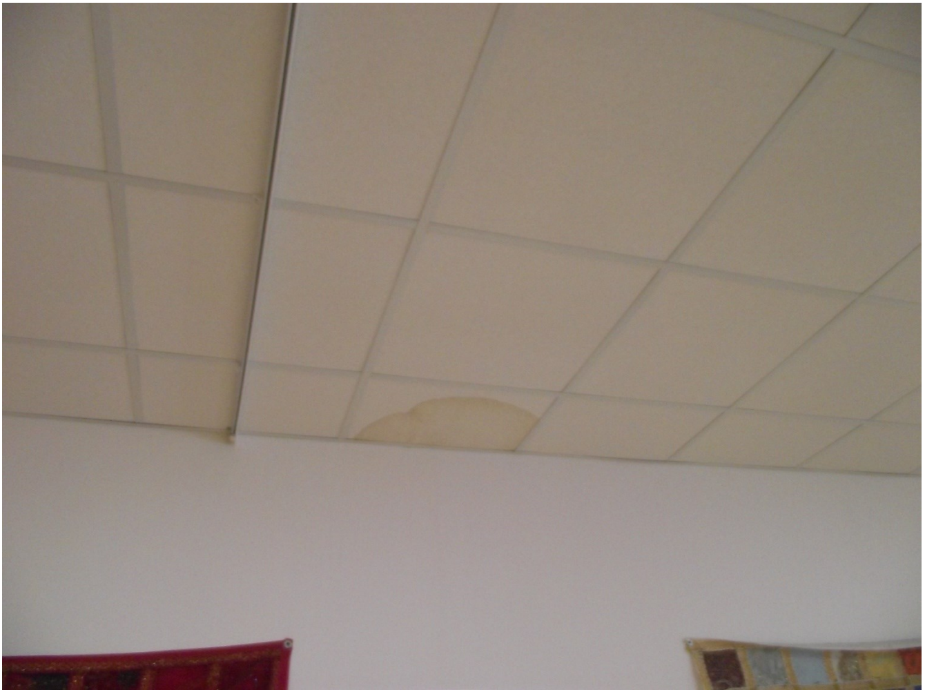
Foto 19 – infiltrazione su sala comune
