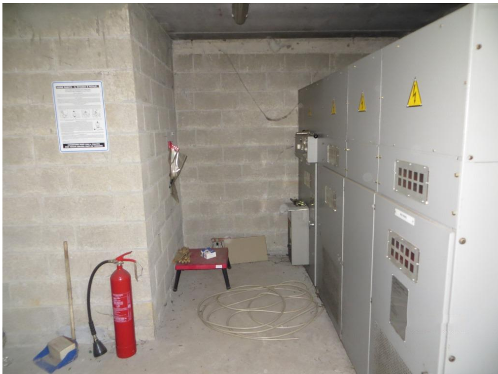
Foto 93 – Interno cabina elettrica
