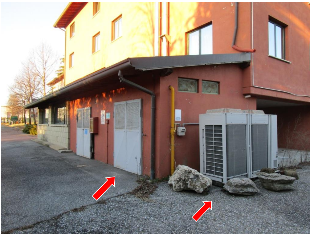
Foto 60 – vista dell'albergo dal cortile comune. Con le frecce vengono indicate la centrale termica e l'impianto di raffreddamento
