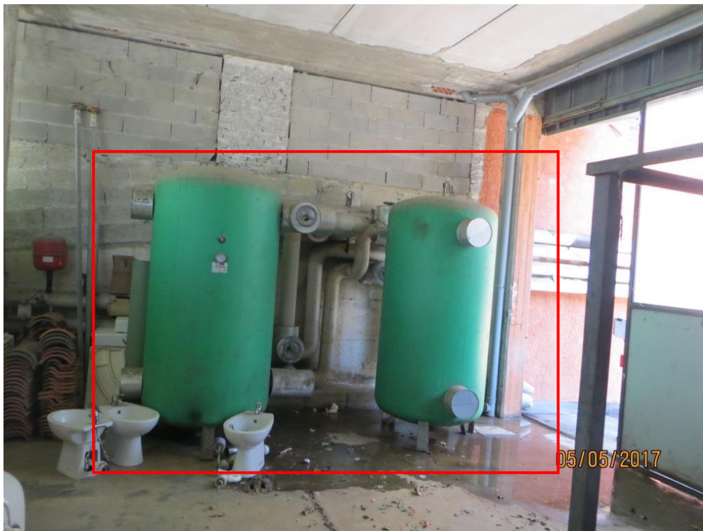
Foto 58 – Interno del magazzino con presenza di serbatoi di accumulo (part 609 sub 704)
