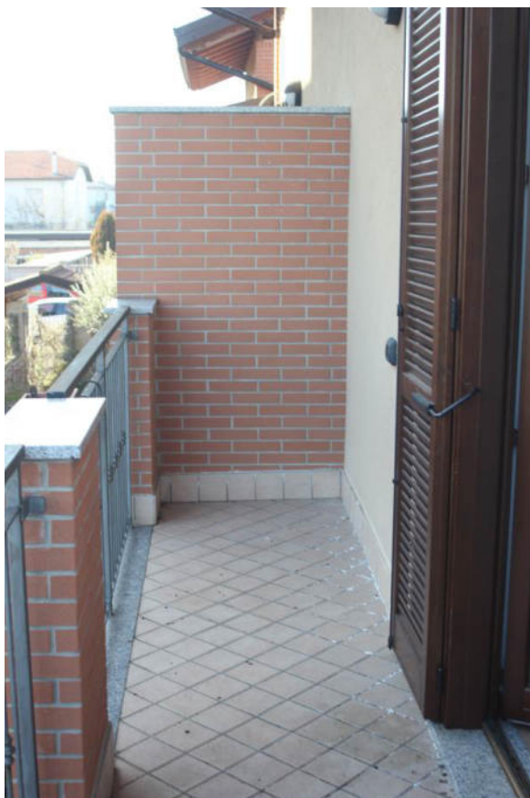
FOTO 9: MARCALLO CON CASONE, VIA BECCARIA 12-18, balcone 1° piano
