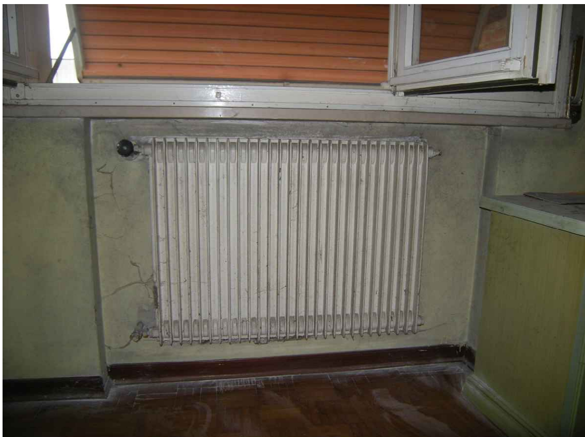
Maron di Brugnera, via I Maggio s.n° - Particolare dei terminali dell'impianto termico.
