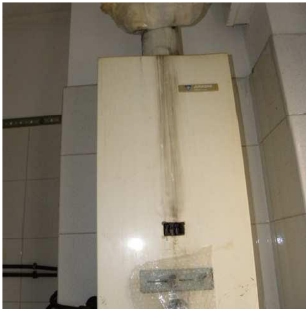
Dettaglio Caldaia per ACS
