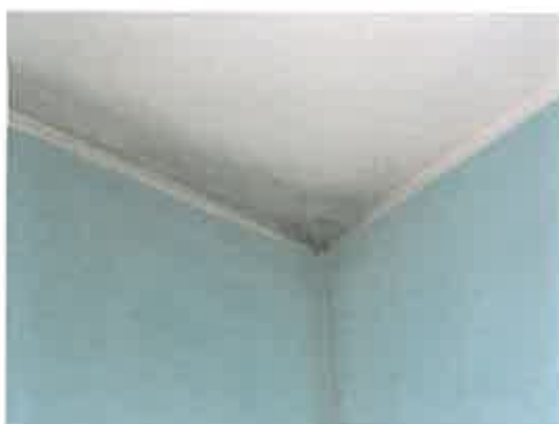
28. Macchie di condensa nella camera
