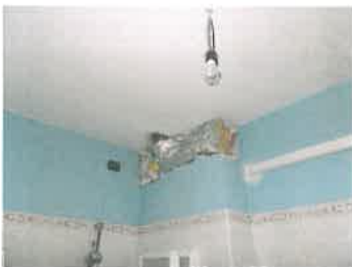
27. Rotture nella muratura
