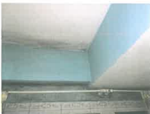
30. Macchie di condensa nel bagno
