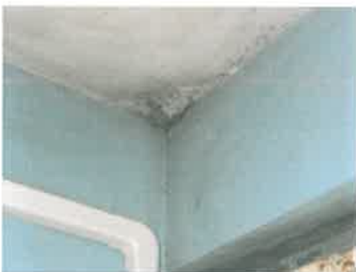
29. Macchie di condensa nel bagno
