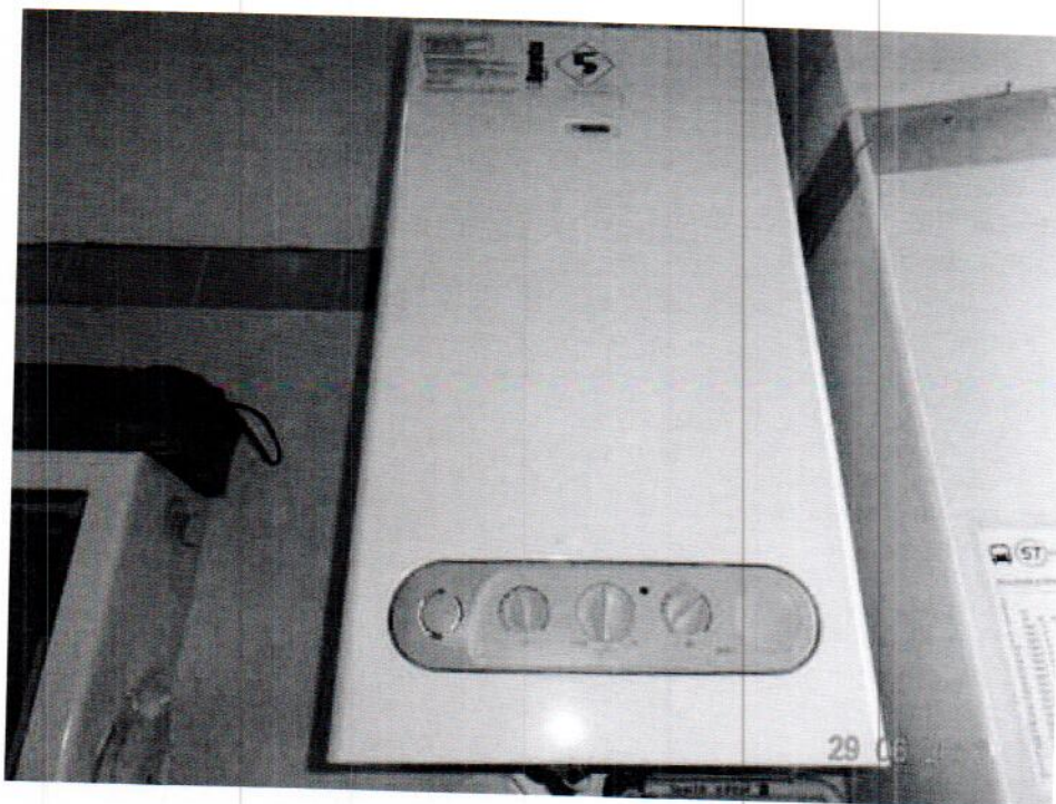
Vista interna - dettaglio caldaia
