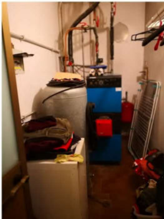
1.57 centrale termica e autoclave
