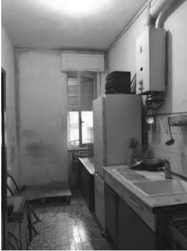
Immagine 11. La cucina. Sulla parete di fondo si nota la presenza di umidità.
