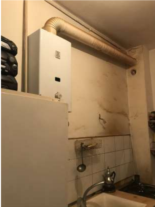
Immagine 13. La cucina, dettaglio della collocazione della caldaia.
