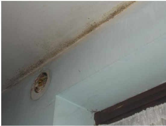
47. Muffa a soffitto
