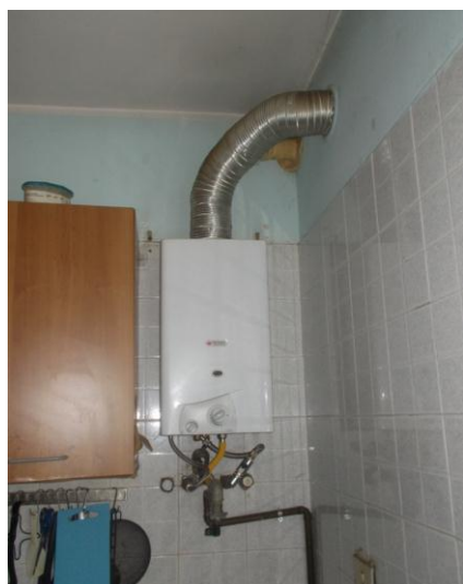
43. Caldaia in cucina (non funzionante)
