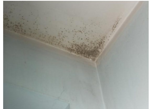
48. Muffa a soffitto
