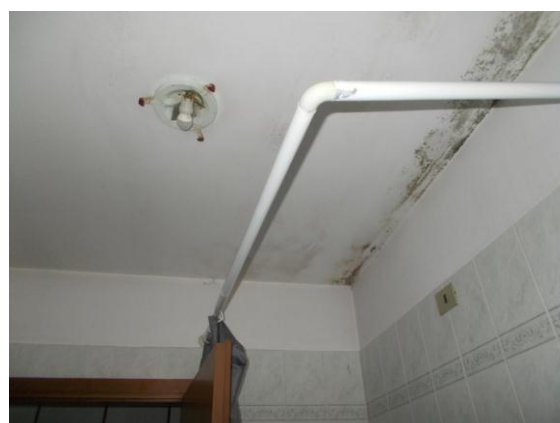
24. Muffe nel bagno (zona vasca/doccia)
