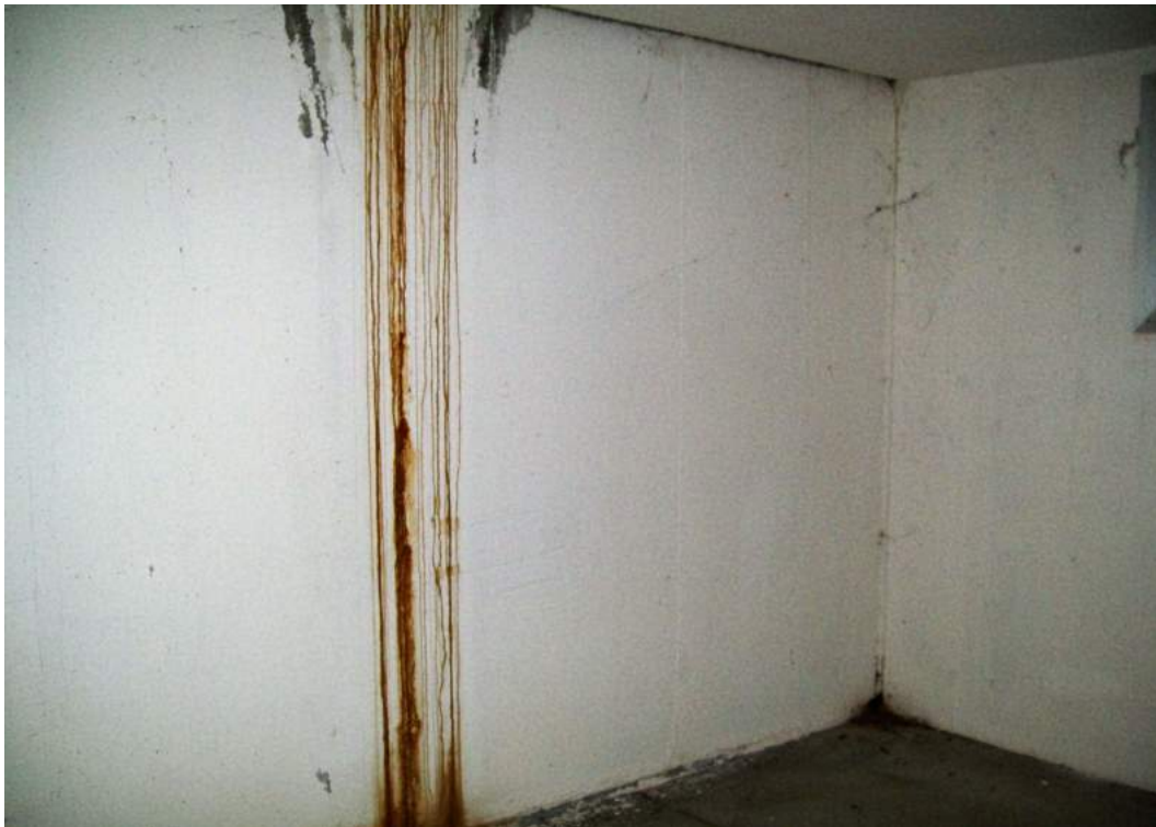
Foto 49d.10: infiltrazione soffitto garage
