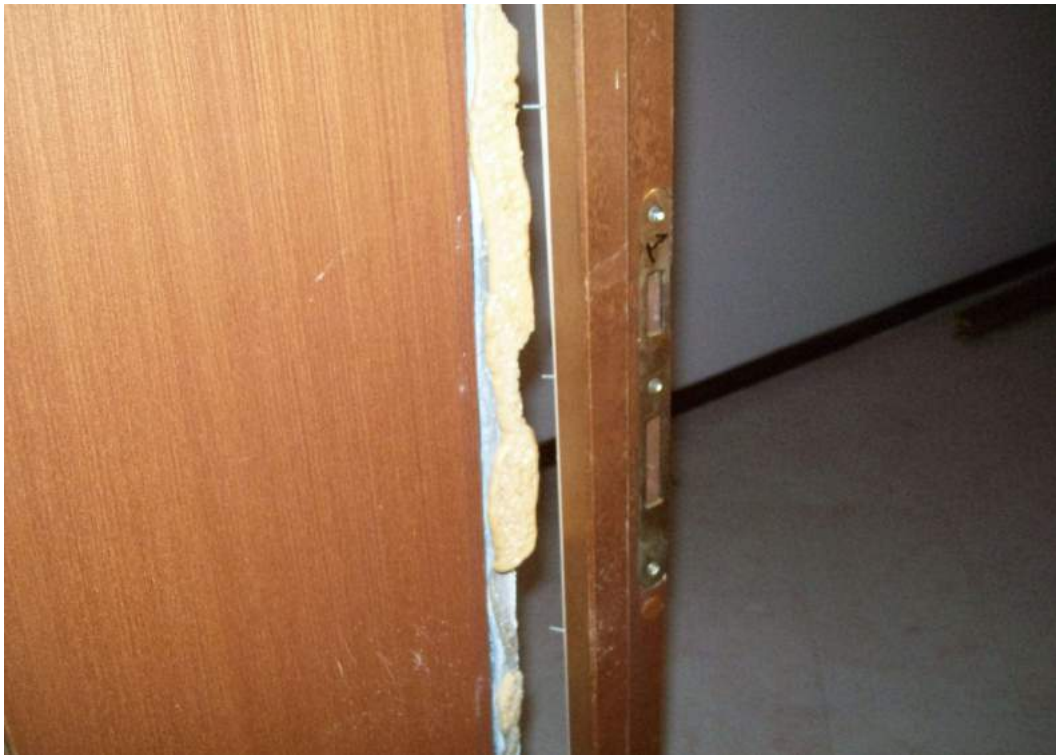
Foto 49d.6: particolare porta con telaio staccato
