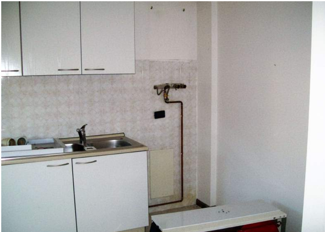
Foto 49d.2: cucina con gruppo termico manomesso
