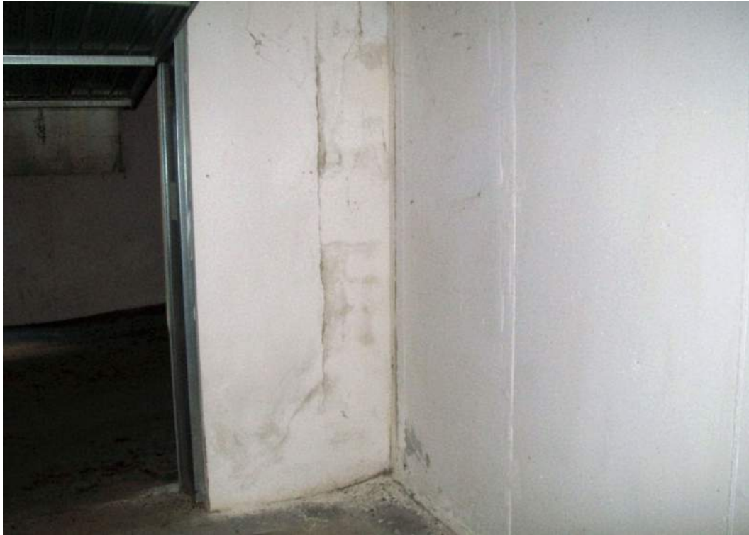
Foto 49d.9: infiltrazione angolo garage
