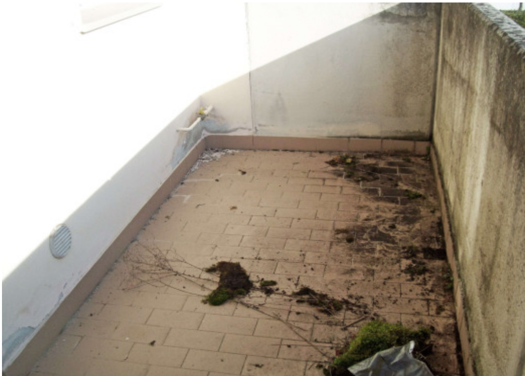
Foto 41e.6: terrazzo con infiltrazioni
