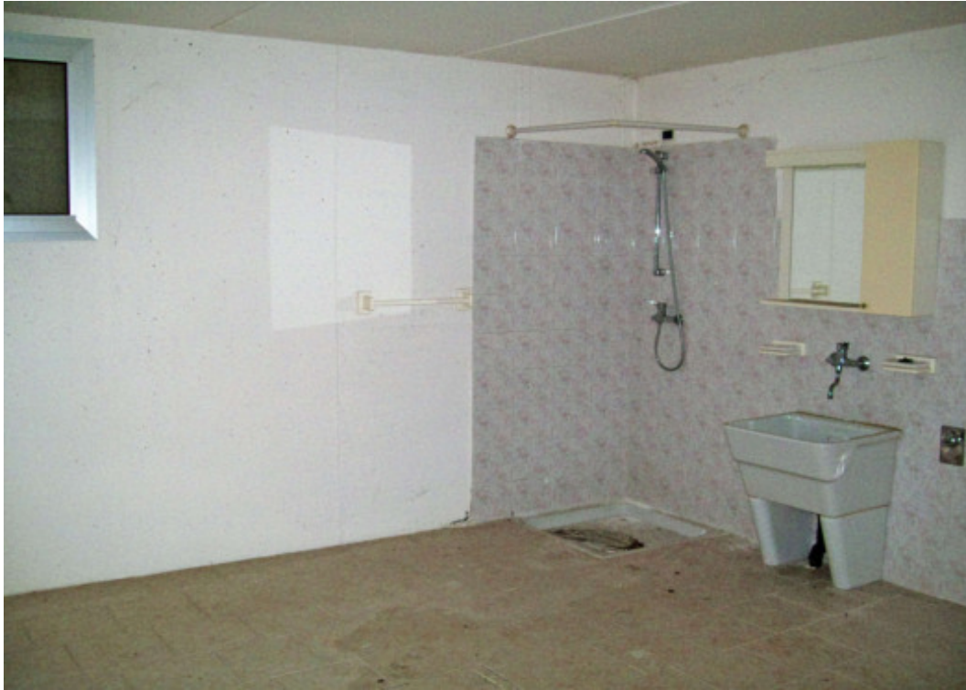
Foto 41e.9: interno lavanderia piano interrato
