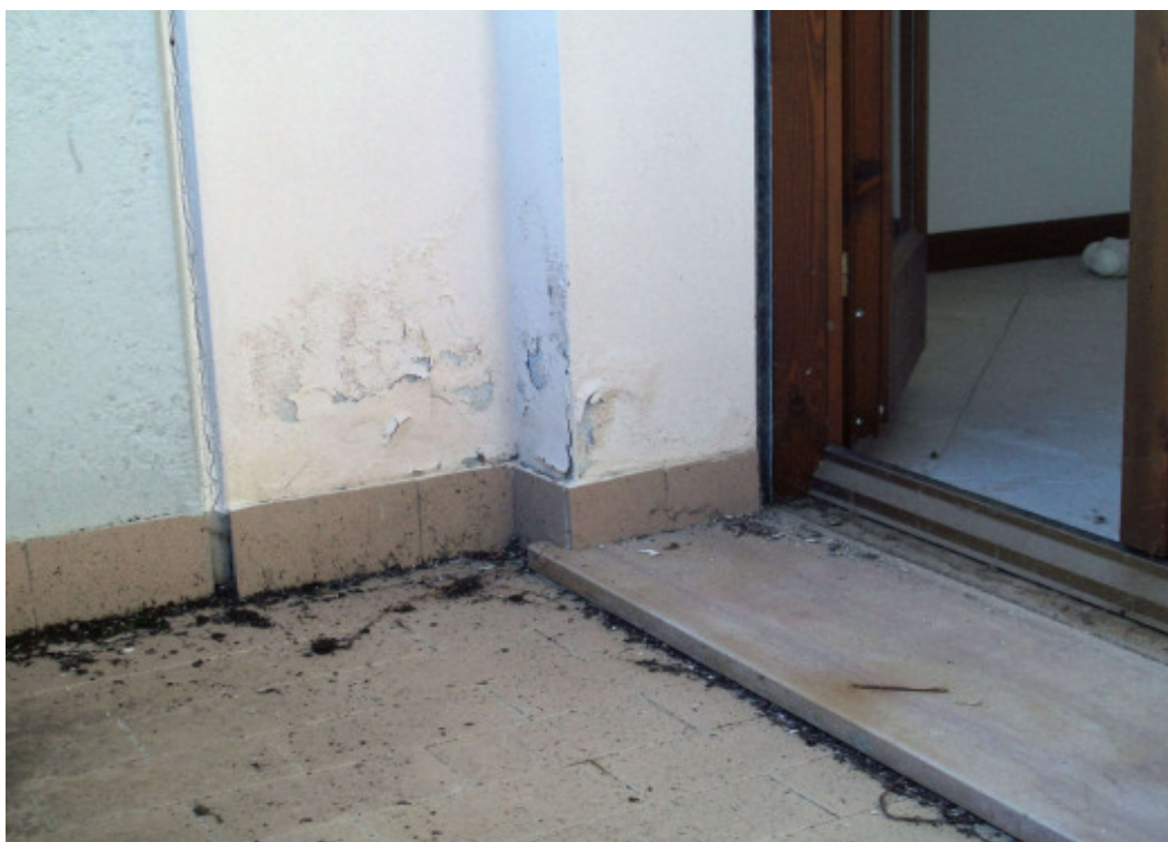
Foto 41e.7: particolare infiltrazioni parete esterna
