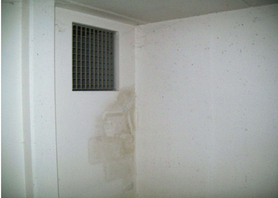
Foto 41e.11: particolare infiltrazione garage piano interrato
