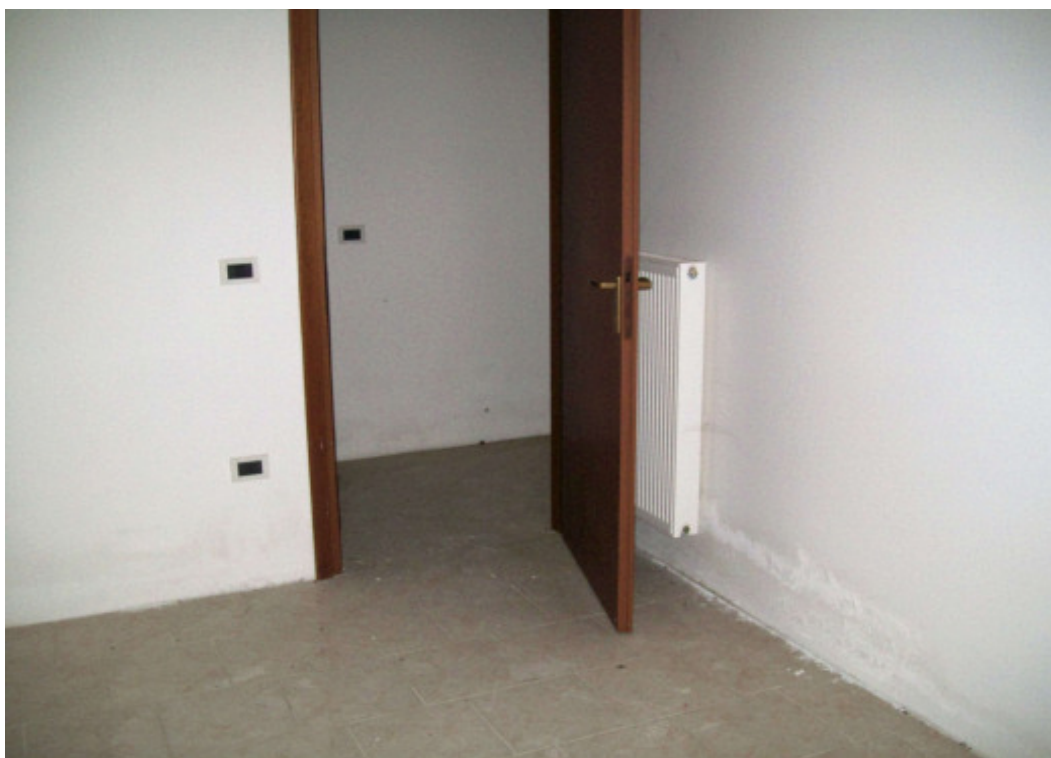
Foto 41e.8: ingresso lavanderia piano seminterrato con infiltrazioni
