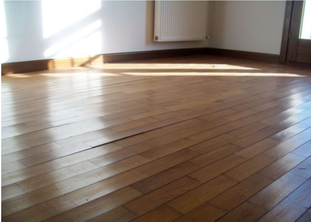
Foto 41e.5: particolare pavimento ligneo deformato
