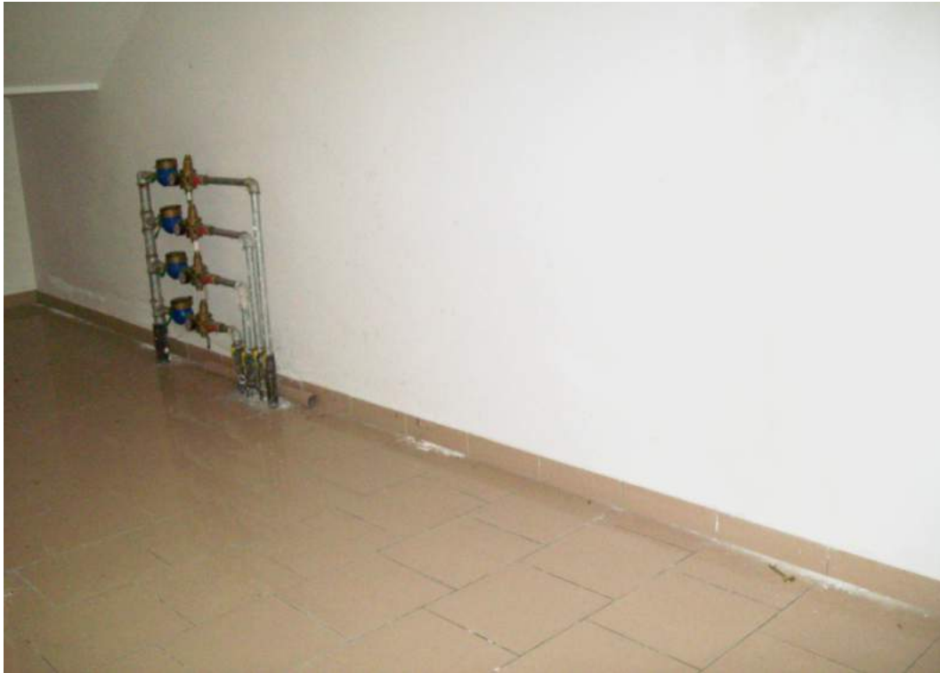
Foto 45.9: contatori acqua piano vano scale piano interrato
