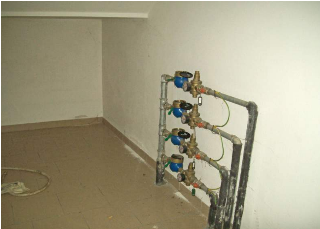
Foto 43.6: contatori acqua vano scale piano interrato
