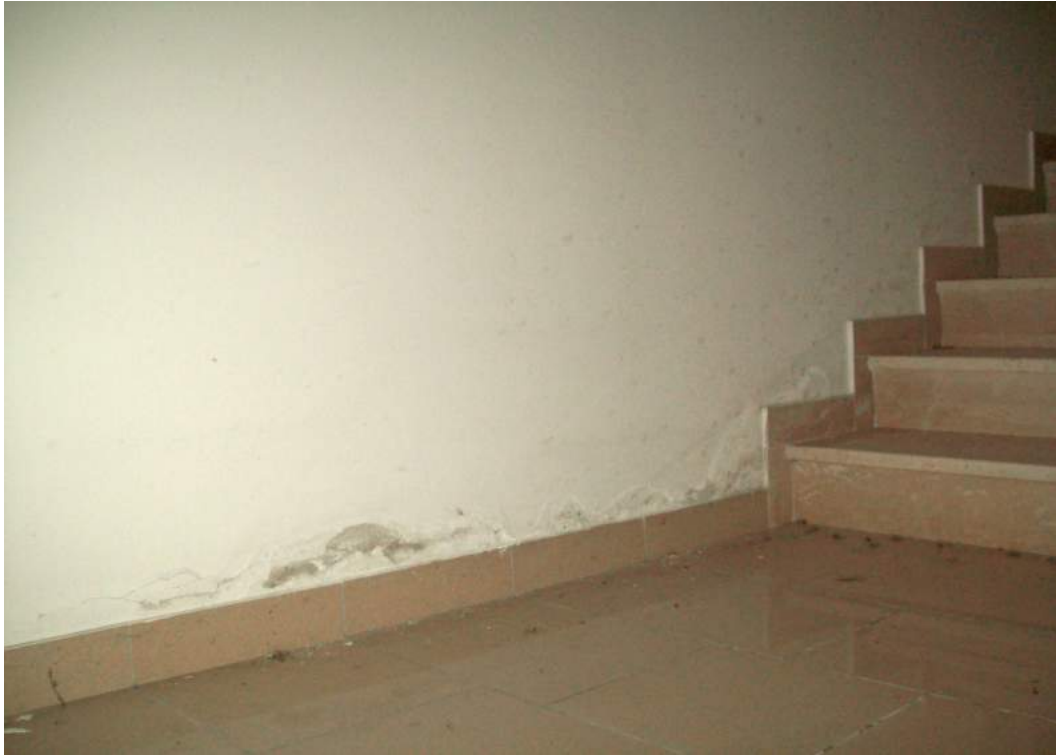
Foto 45.7: vano scale piano interrato, particolare infiltrazioni
