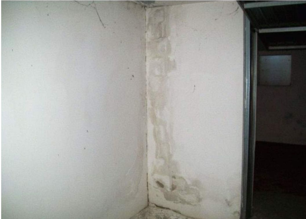
Foto 45d.7: infiltrazioni garage piano interrato
