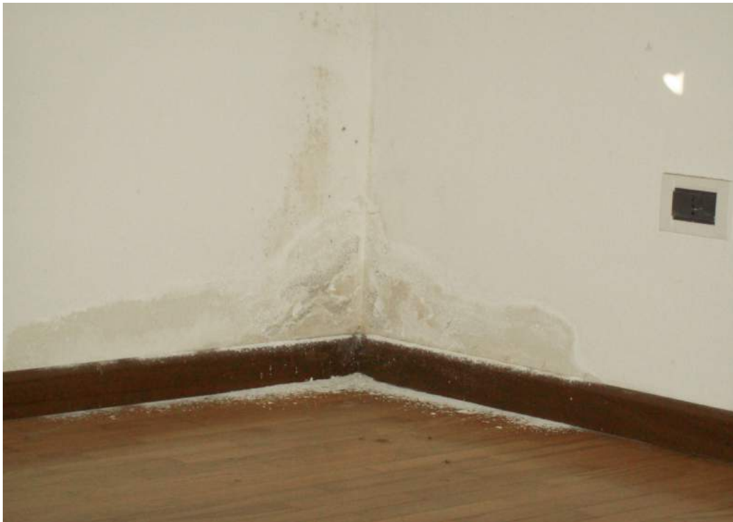
Foto 45d.4: infiltrazione camera
