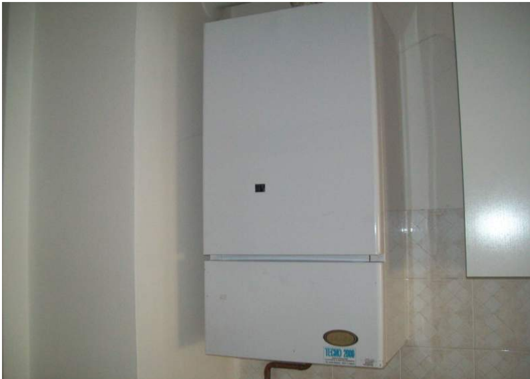
Foto 45c.2: gruppo termico cucina
