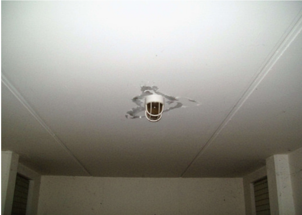
Foto 41d.13: infiltrazione soffitto garage piano interrato
