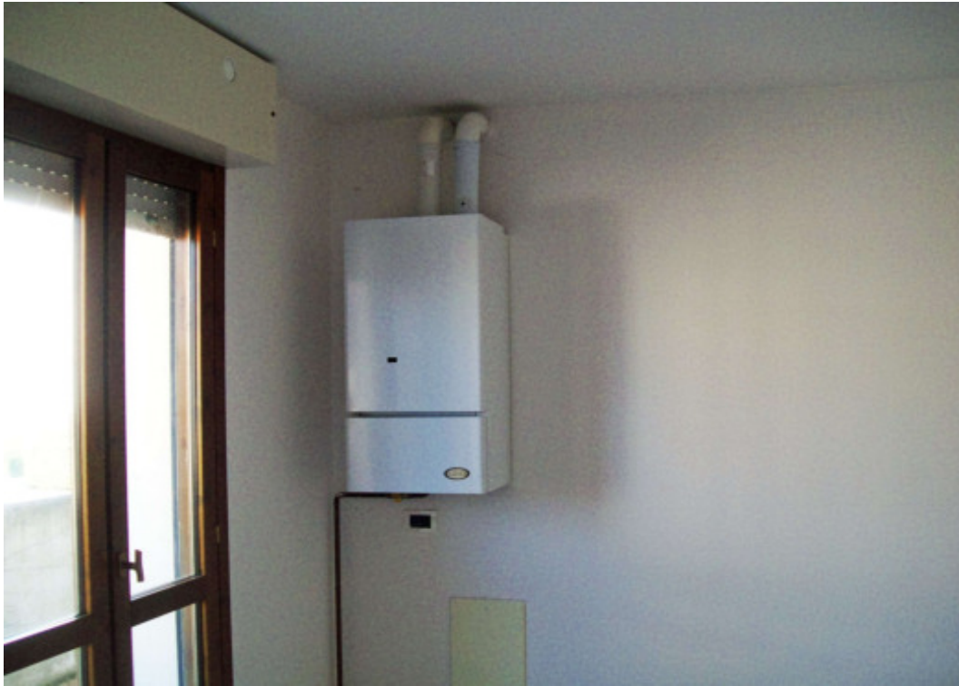
Foto 41d.5: particolare gruppo termico installato in soggiorno
