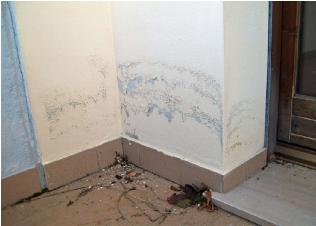
Foto 41d.3: particolare infiltrazioni pareti esterne appartamento
