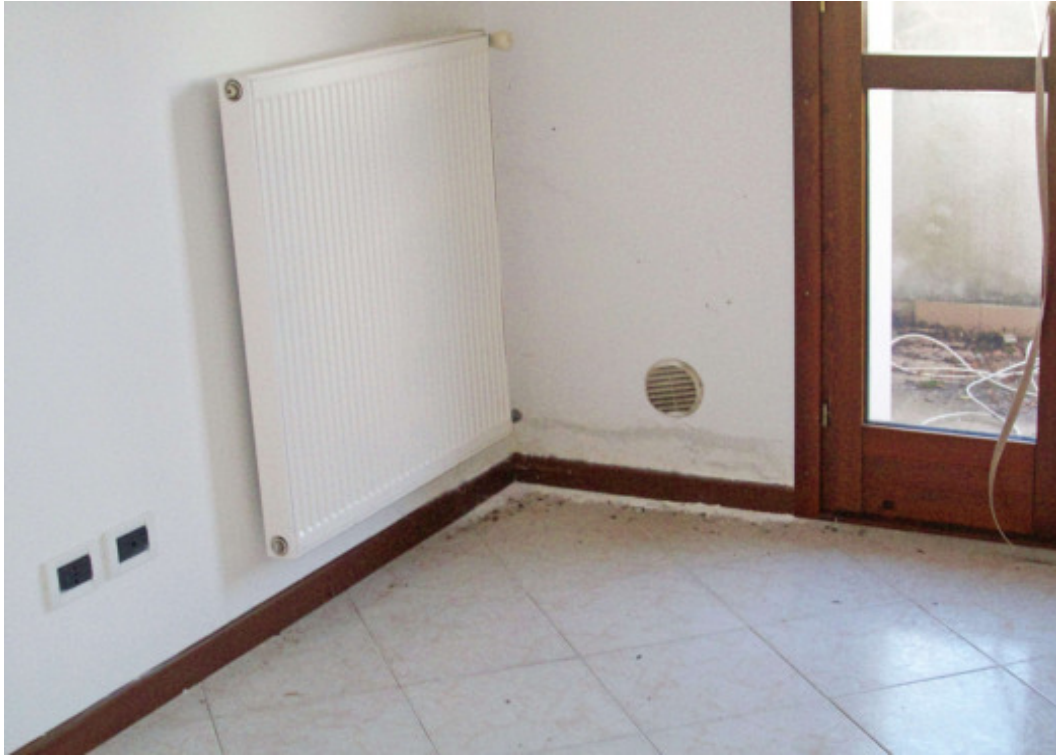
Foto 41d.1: infiltrazioni parete Ovest soggiorno
