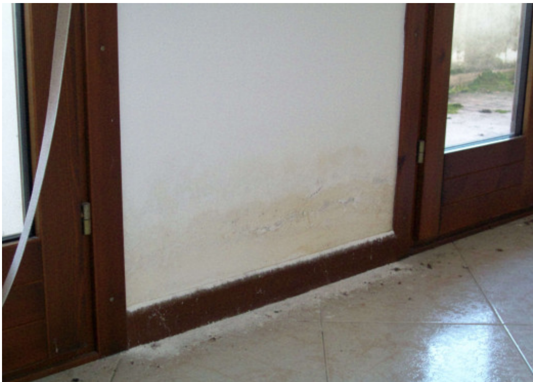
Foto 41d.6: particolare infiltrazione parete Ovest soggiorno
