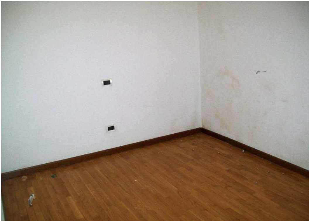
Foto 49c.4: camera con infiltrazioni
