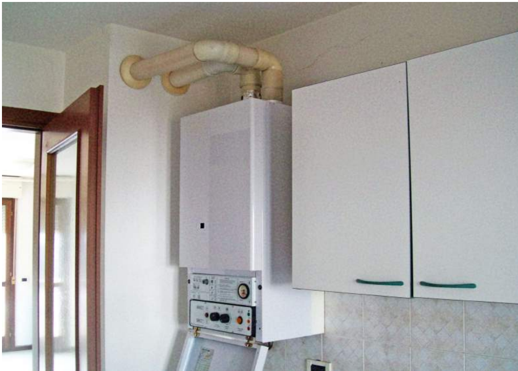
Foto 49c.2: cucina con gruppo termico
