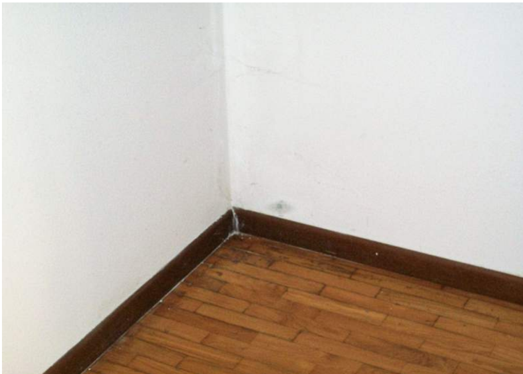
Foto 49b.4: infiltrazione angolo camera
