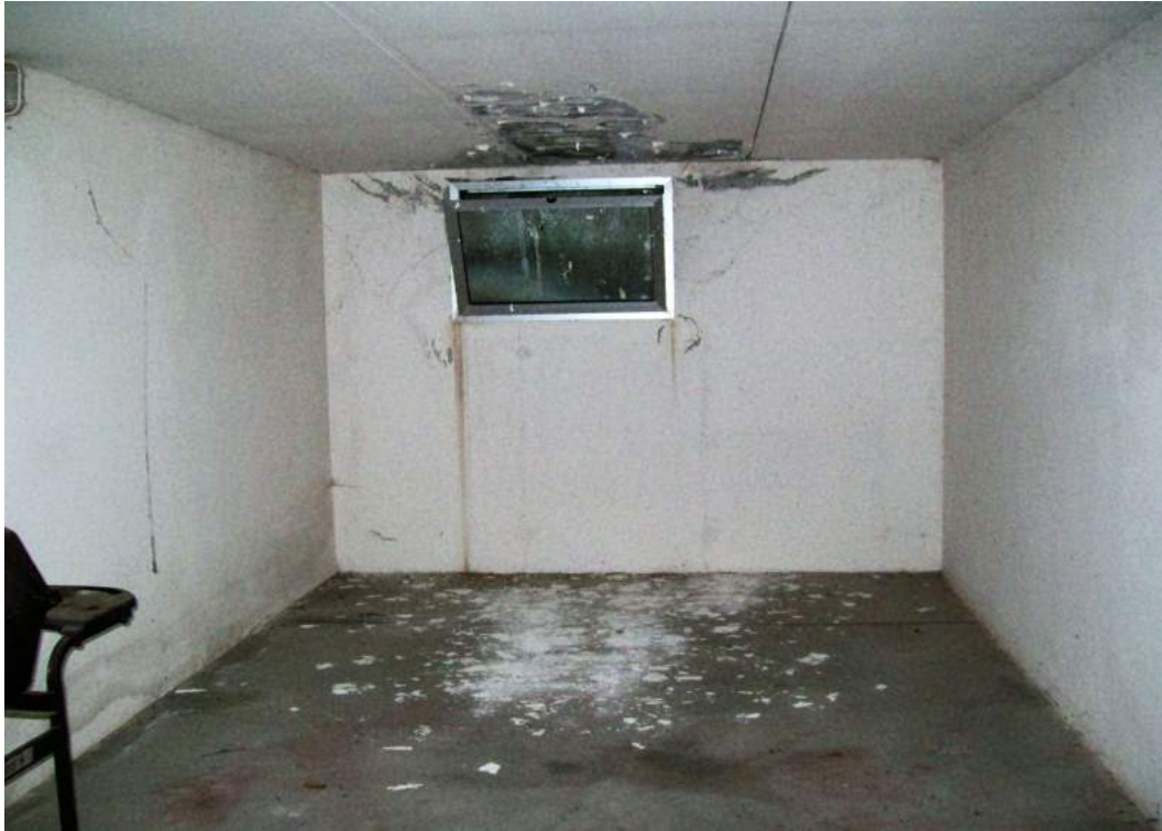
Foto 49a.7: infiltrazioni garage piano interrato
