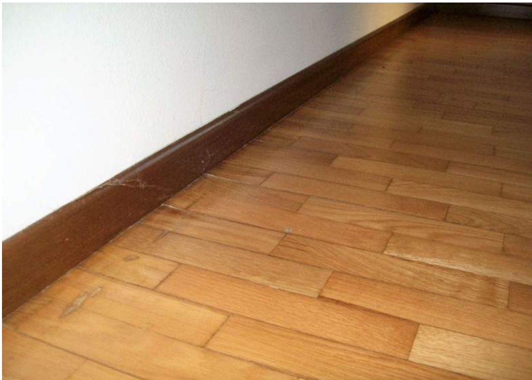
Foto 49a.6: particolare pavimento ligneo sollevato
