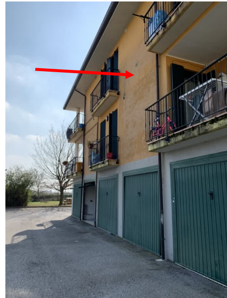
particolare lieve degrado della tinteggiatura nel lato est
