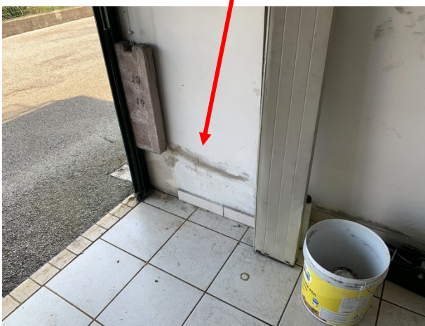
particolare lieve umidità di risalita nell'autorimessa
