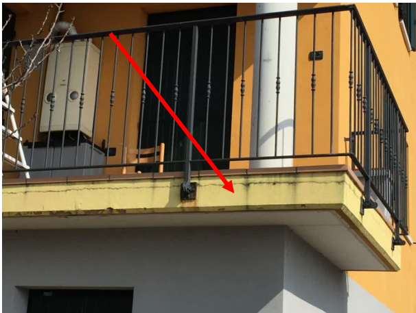
particolare lieve degrado della tinteggiatura nella testata della terrazza
