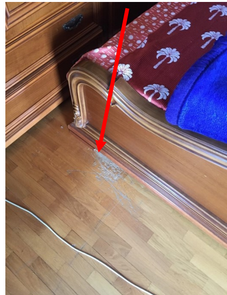
particolare difetto nella pavimentazione della camera matrimoniale
