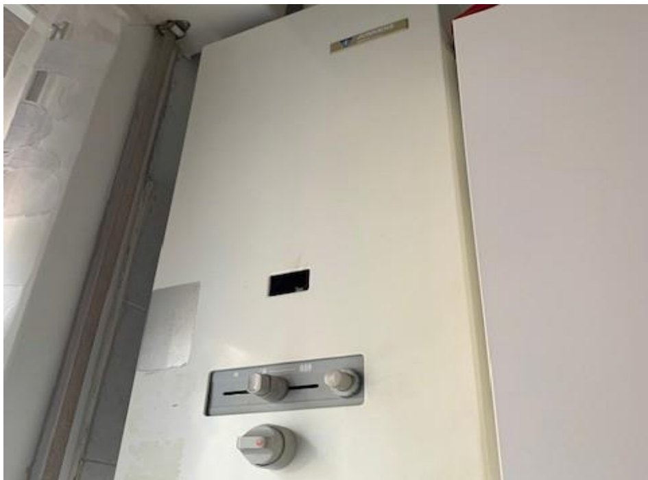
Vista interna - boiler
