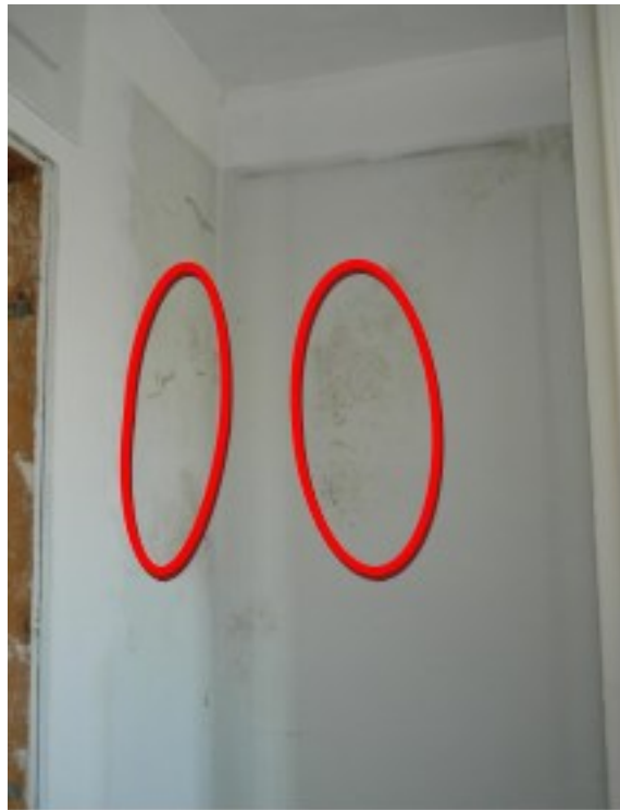
Presenza di muffe camera da letto Piano Primo
