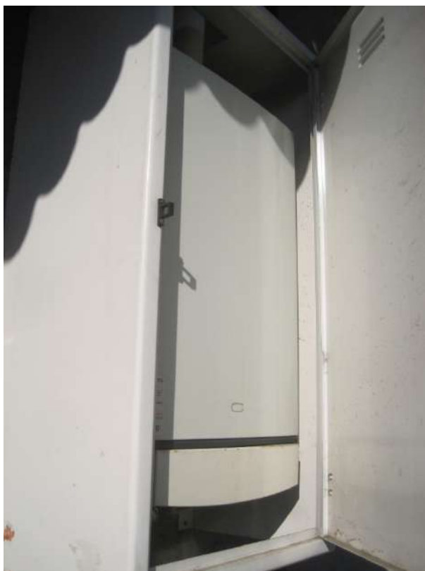
Dettagli – Caldaia a gas metano
