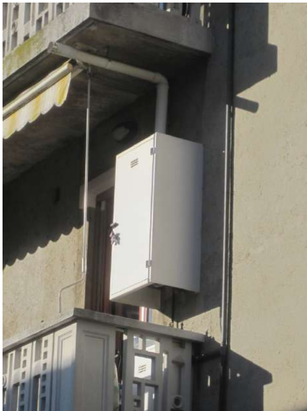
Dettagli – Caldaia a gas metano
