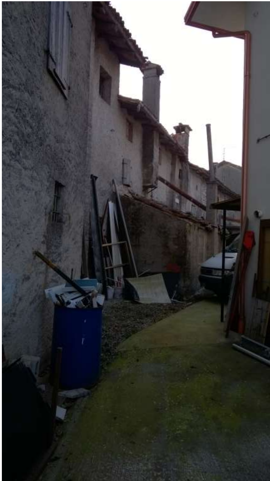
LOTTO 3 - Castions di Zoppola, via Nicolò Fortuni - I prospetti a nord est dei fabbricati al NCEU del Comune di Zoppola al foglio 19, particelle n. 1073, 307, 306, 991.
