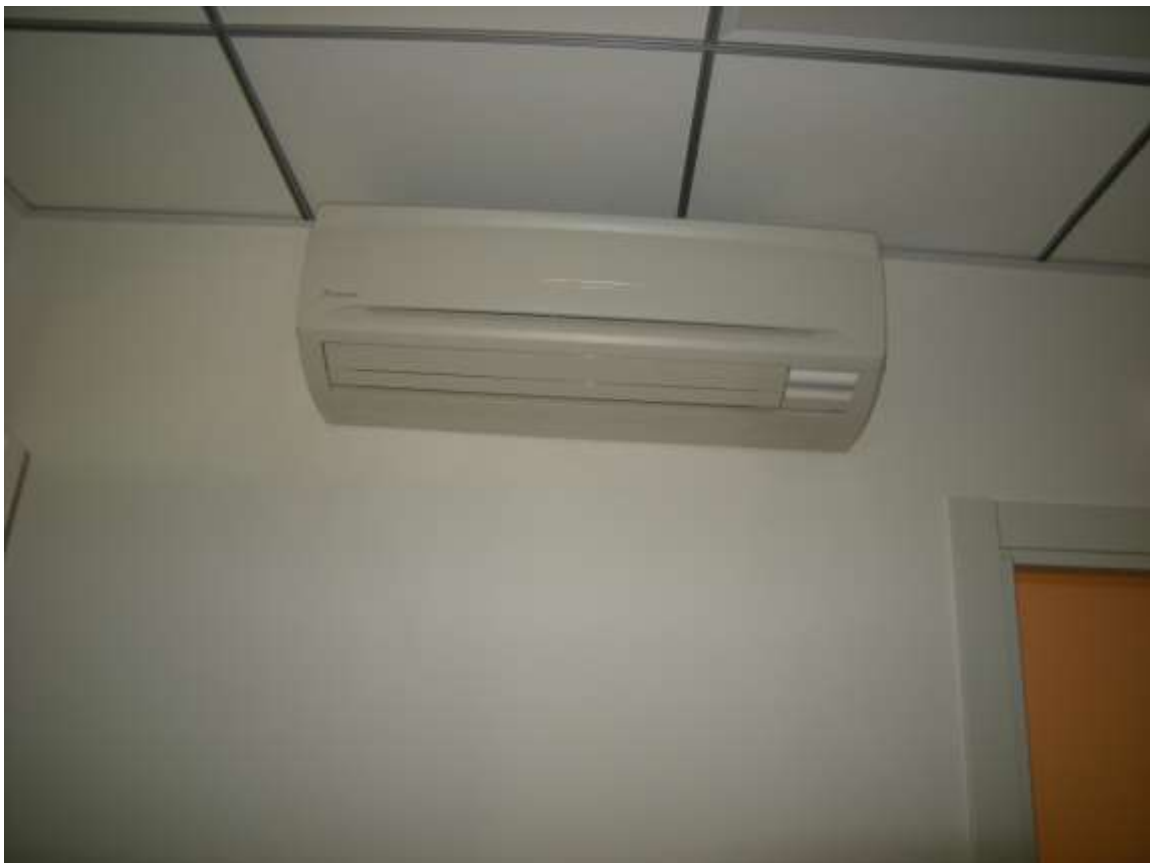
LOTTO 1- Castions di Zoppola, via Nicolò Fortuni, foglio 19, particella 1146, sub 36 – Particolare dell'impianto di climatizzazione.
