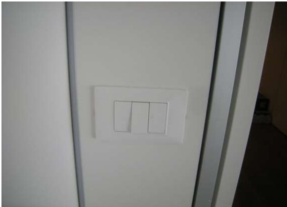
LOTTO 1- Castions di Zoppola, via Nicolò Fortuni, foglio 19, particella 1146, sub 36 – Particolari dell'impianto elettrico.
