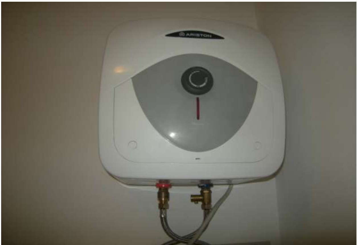
LOTTO 1- Castions di Zoppola, via Nicolò Fortuni, foglio 19, particella 1146, sub 36 – In alto il crono termostato, in basso lo scaldacqua.
