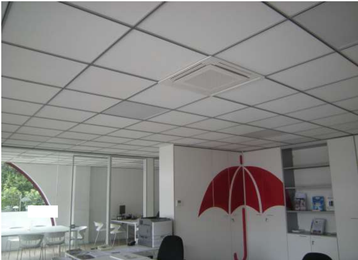
LOTTO 1- Castions di Zoppola, via Nicolò Fortuni, foglio 19, particella 1146, sub 36 – Particolare dell'impianto di climatizzazione.
