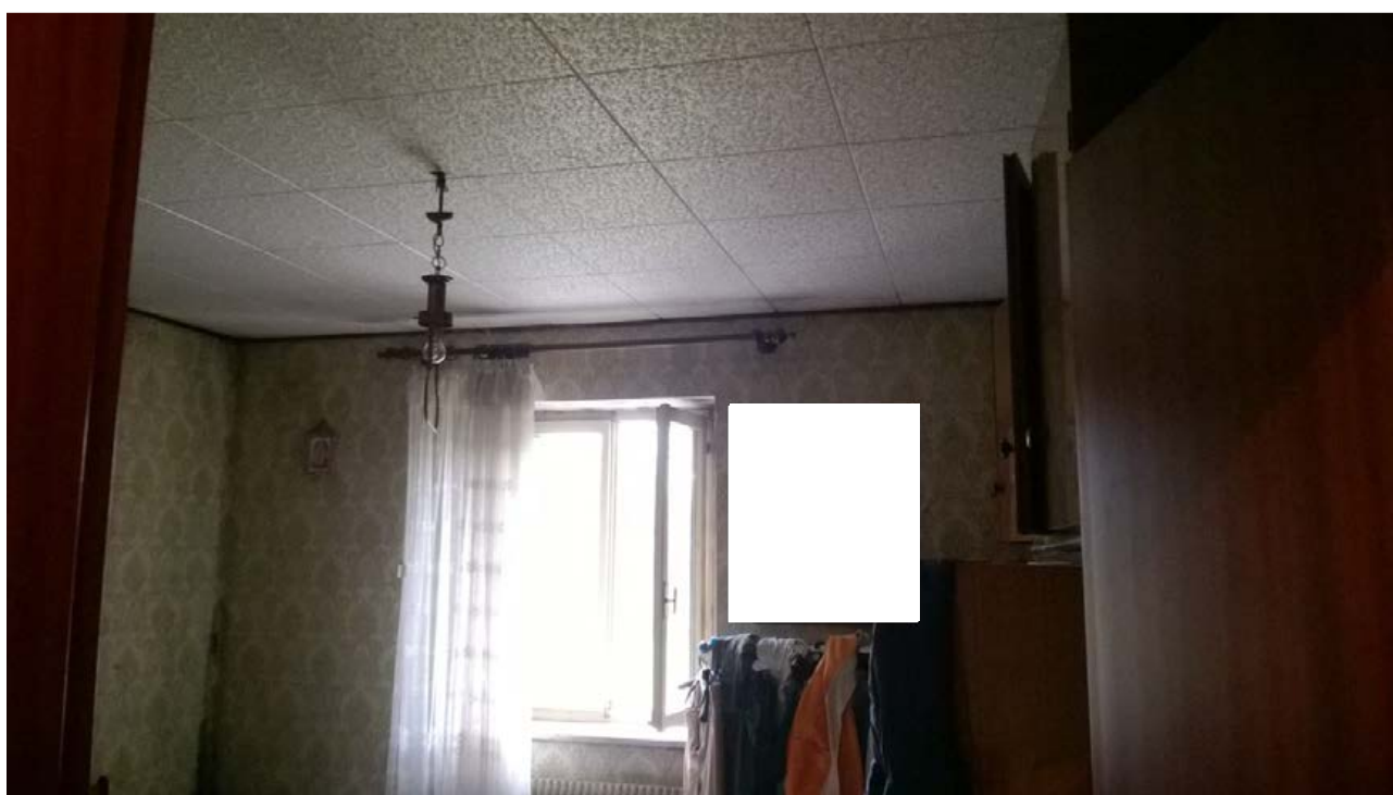
Foto n. 19 - Comune di Vivaro (PN) - frazione Tesis - Particella n. 730 del foglio 7 – Veduta della 3° camera, adiacente al bagno.
