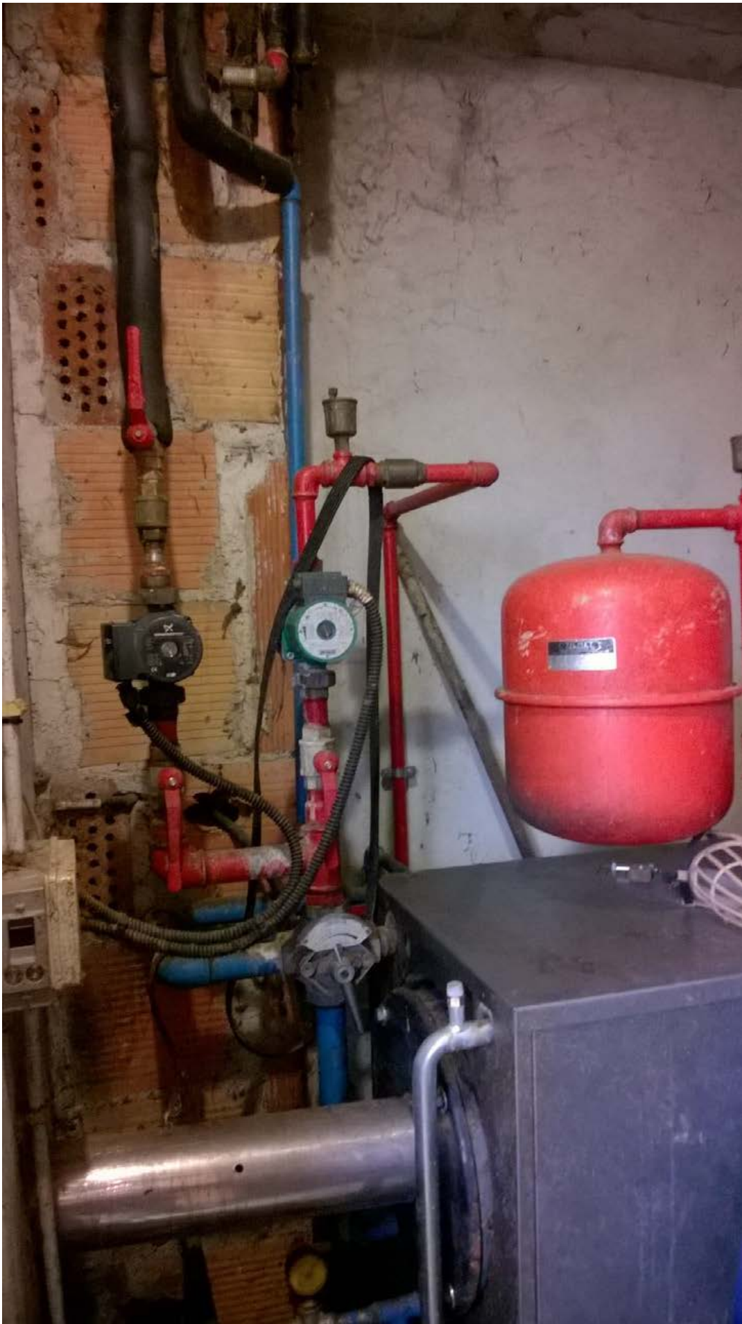
Foto n. 28 - Comune di Vivaro (PN) - frazione Tesis - Particella n. 730 del foglio 7 - Particolare dell'interno del vano C.T.
