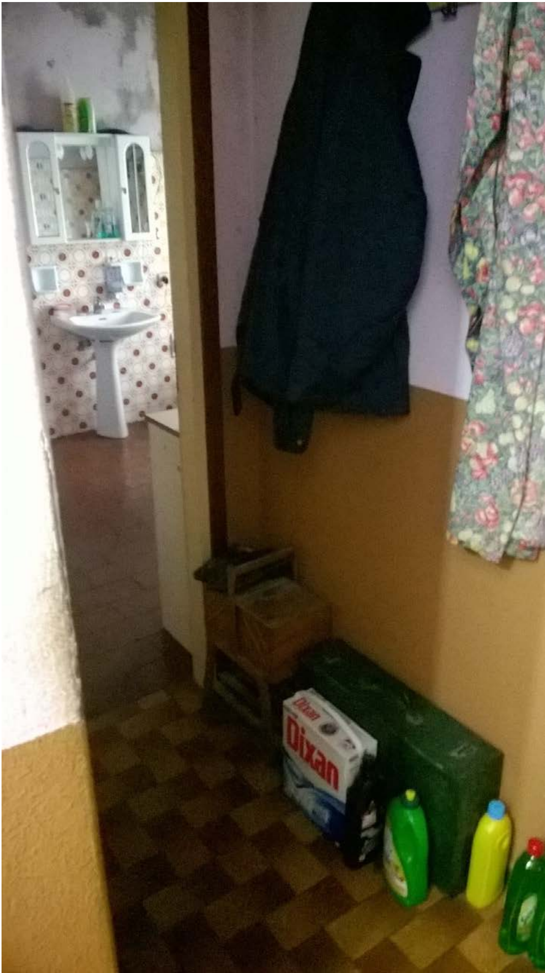
Foto n. 9 - Comune di Vivaro (PN) - frazione Tesis - Particella n. 730 del foglio 7 - Disimpegno da cui si accede al bagno a piano terra.
