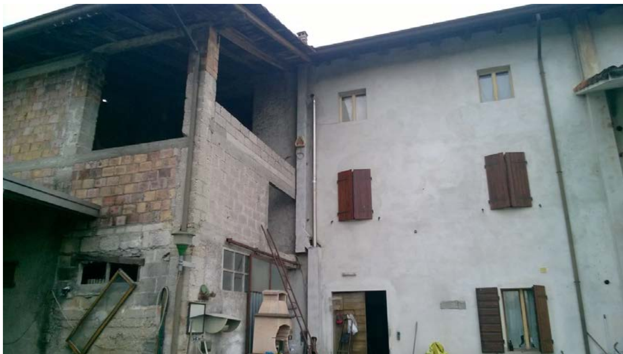
Foto n. 26 - Comune di Vivaro (PN) - frazione Tesis - Particella n. 730 del foglio 7 - Veduta esterna della porzione del fabbricato destinata a cantina e ripostigli.
