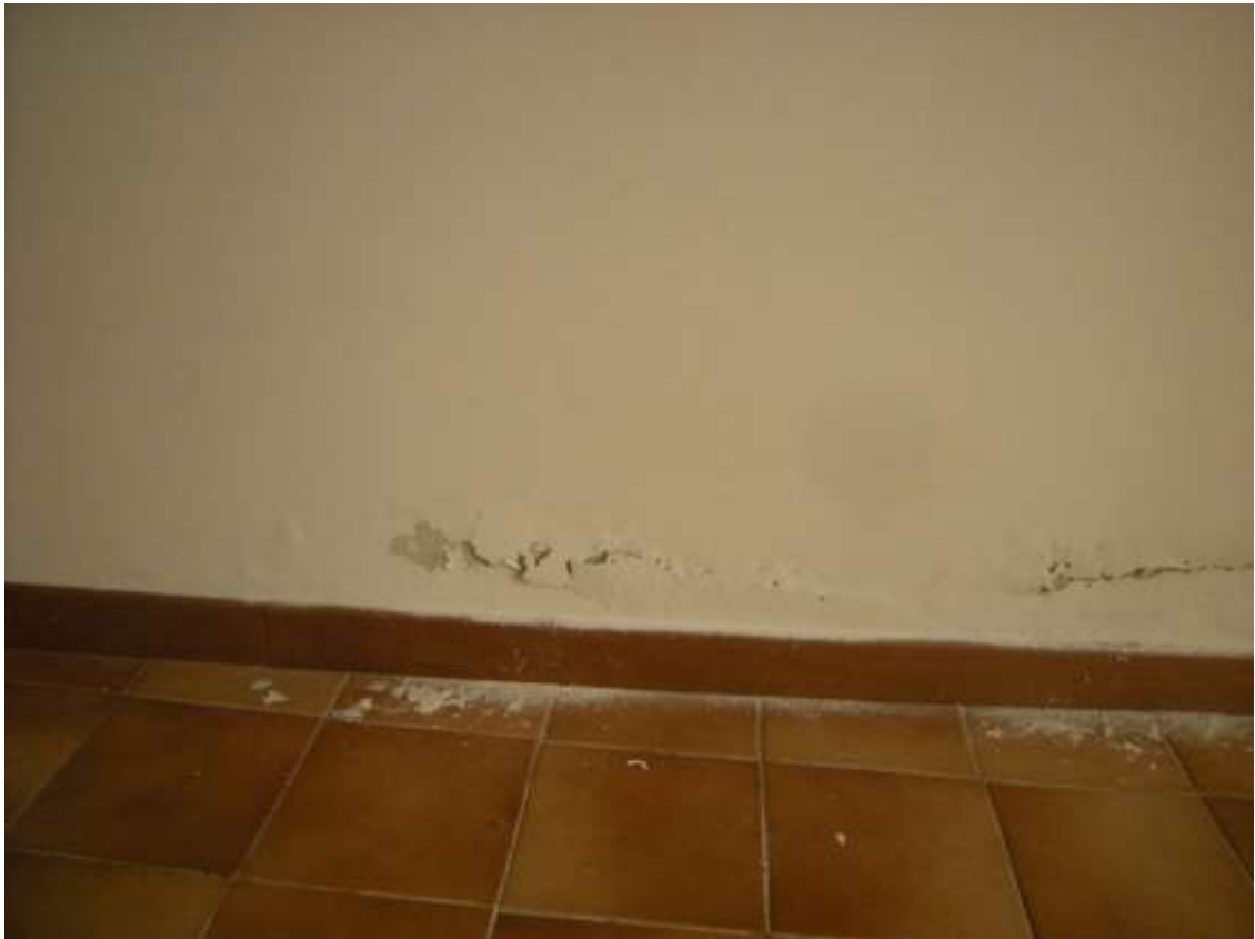
Budoia, via Cardazzo n°. 13 – Sopra il locale con destinazione laboratorio, sotto il particolare dei danni all'intonaco.
