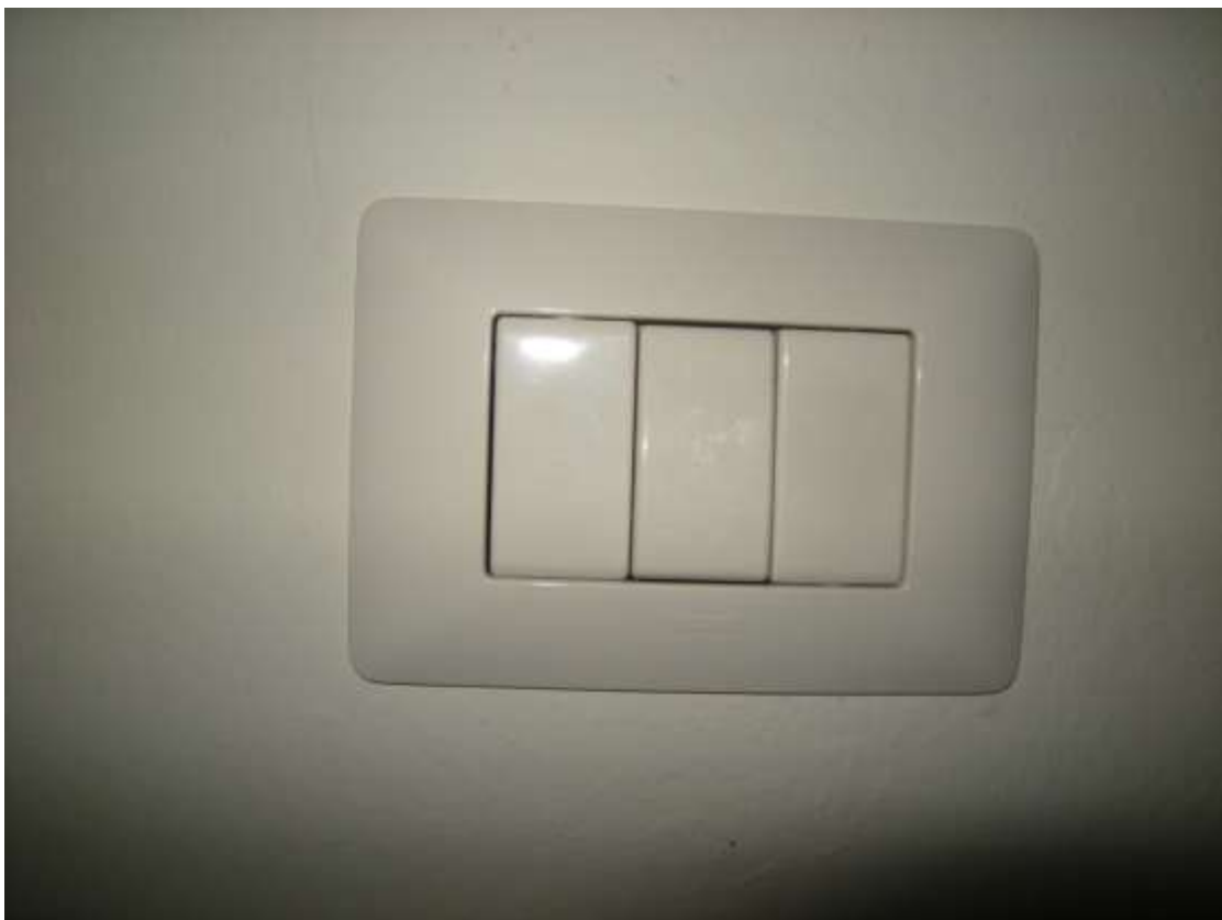
Budoia, via Cardazzo n°. 13 – Particolari dell'impianto elettrico.
