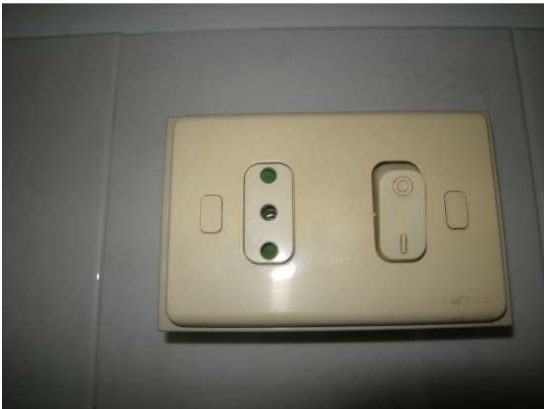
Budoia, via Cardazzo n°. 13 – Particolari dell'impianto elettrico.
