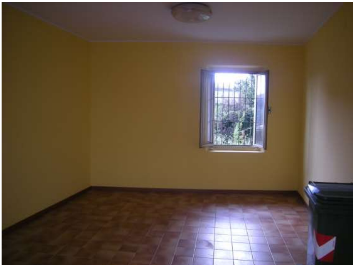
Budoia, via Cardazzo n°. 13 – Il locale con destinazione punto vendita per pizze d'asporto.
