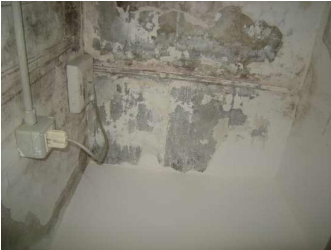
Budoia, via Cardazzo n°. 13, WC - Danni agli intonaci.
