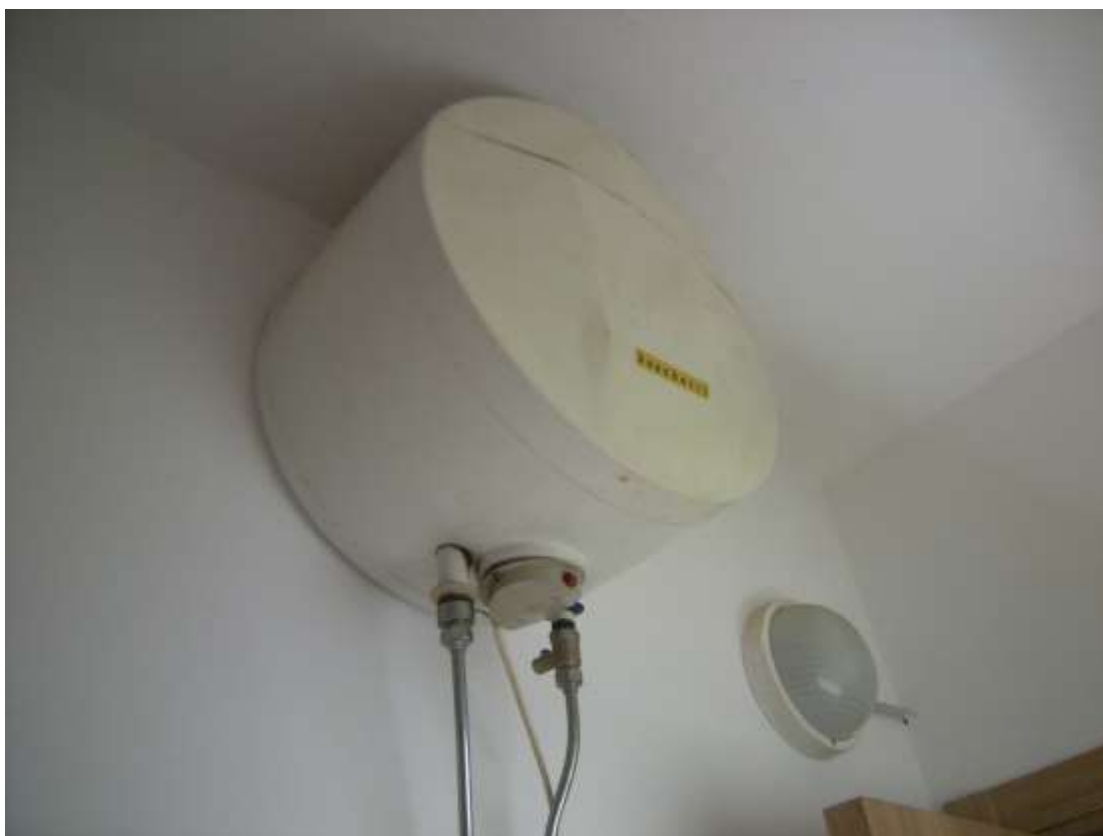
Budoia, via Cardazzo n°. 13 – Lo scaldabagno.
