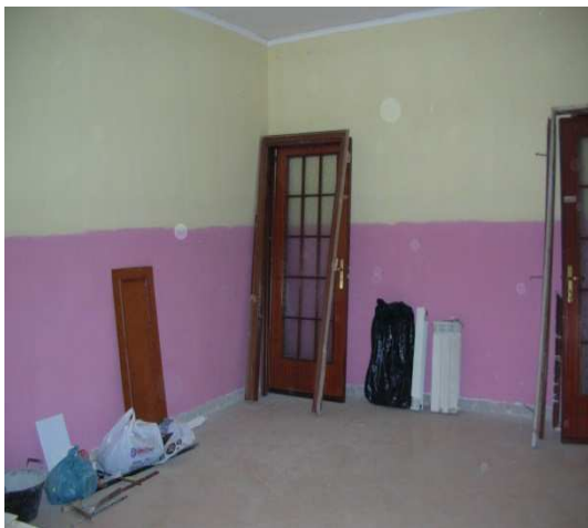
Foto 3 Le porte divelte nell'ingresso
