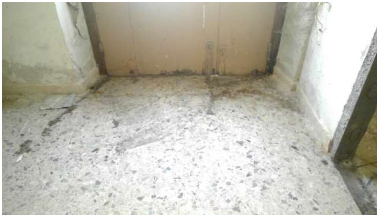
Foto n. 3 – Comune di Travesio (PN) – frazione Toppo - "Corte Dal Nodâr"- Lotto 2 – Foglio 8, Unità 6 – Piano terra – Veduta interna dell'ingresso da Via della Fornace.
