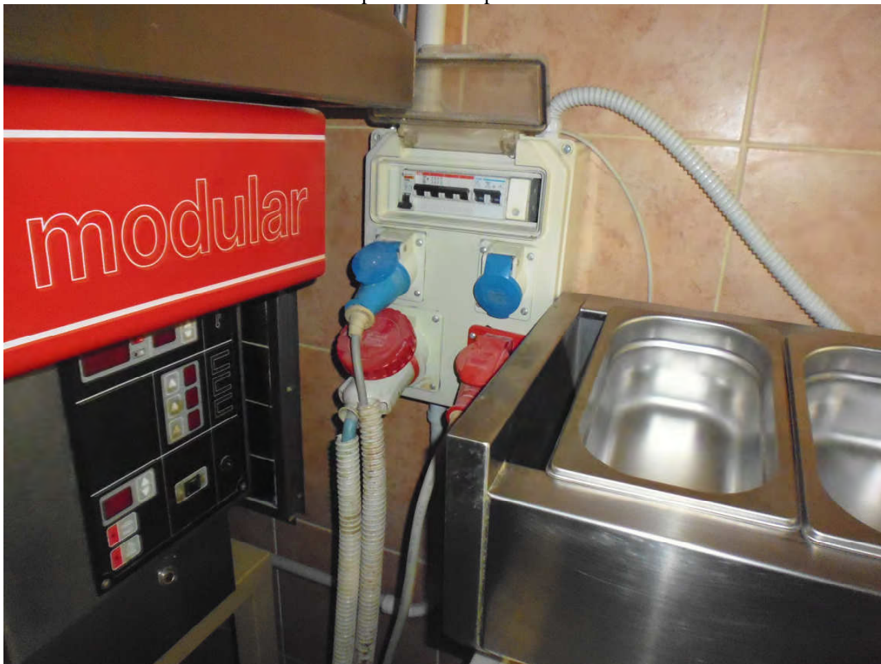
Foto 29 – particolare impianto elettrico
